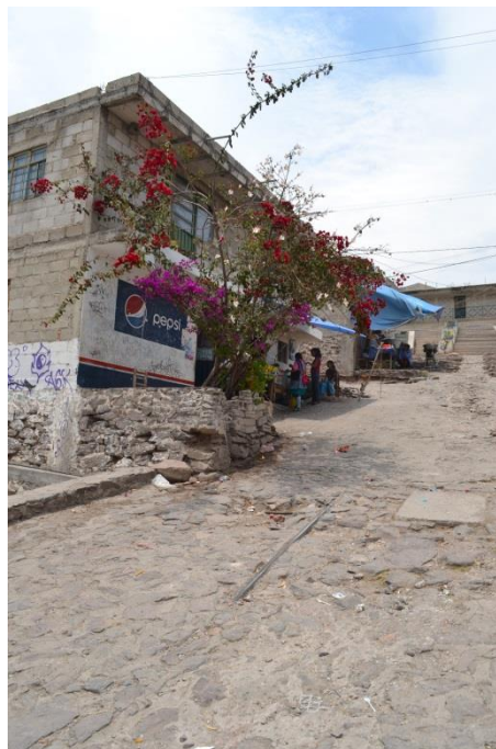
Calle principal con problemas de accesibilidad peatonales (Imagen 2.49) Fuente: Elaboración propia
