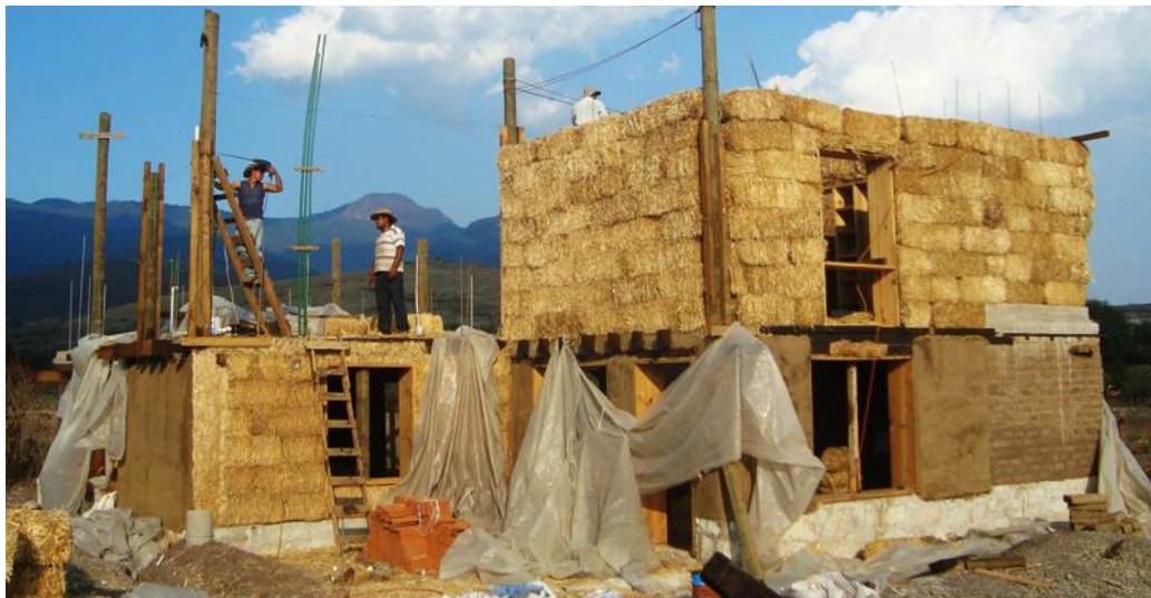
Marcos rígidos de postes telefónicos reciclados (Figura 4.3) Fuente: eco constructores Oaxaca
