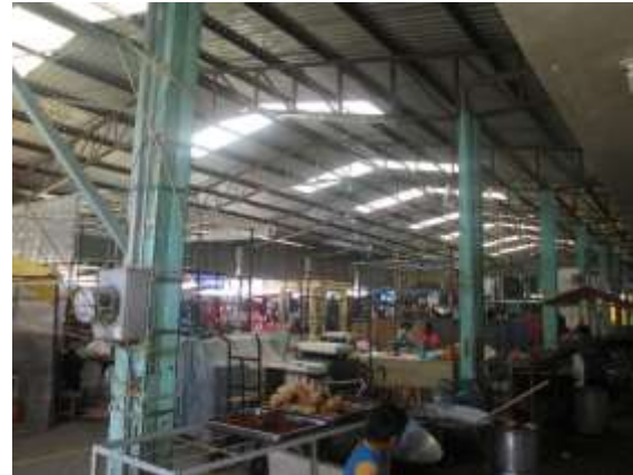
Imagen 15: Vista desde la calle 5 sur del lado noroeste. Se puede ver claramente que su distribución interna no es regular, además de presentar una armadura y cubierta de tipo triangular. La armadura está elaborada con perfil tubular. Se aprecia además el cableado que cuelga o se enreda sobre los elementos estructurales de acero. Foto: Miguel Ángel Flores Carreto 01/04/2017, Canon.
