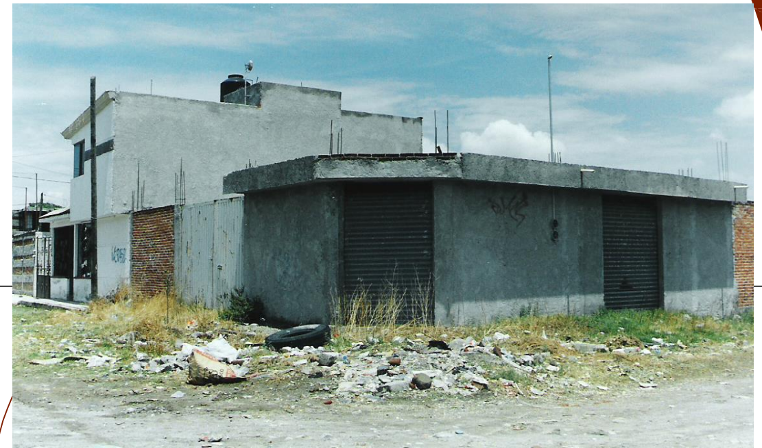
FOTO No. 63 (Izq. Arriba) ESTADO ACTUAL DE CALLES EN LA COLONIA TRES CRUCES. FOTO No. 64 (Der. Arriba) ESTADO ACTUAL DE VIVIENDAS (Autoconstrucción) EN LA COLONIA TRES CRUCES. FOTO No. 65 (Izq. Centro) ESTADO ACTUAL DE CALLES EN LA COLONIA TRES CRUCES. FOTO No. 66 (Der. Centro) ACCESO A ESCUELA. FOTO No. 67 (Abajo) ESTADO ACTUAL DE CALLES EN LA COLONIA TRES CRUCES, PROBLEMAS DE CONTAMINACION.
