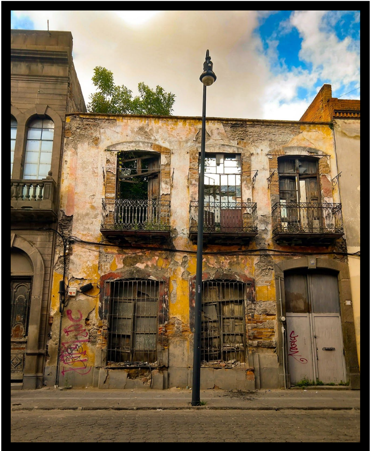
Imagen 36. Fotografía tomada sobre la avenida 10 poniente. En ella podemos observar la fachada de una antigua casona, la cual se ve deteriorada y en ruinas. Autora: Marina E. Hernández Jaramillo. Puebla, Pue. Junio de 2019. Fotografía tomada con un dispositivo móvil. Coordenadas: 19.047917,-98.195687
