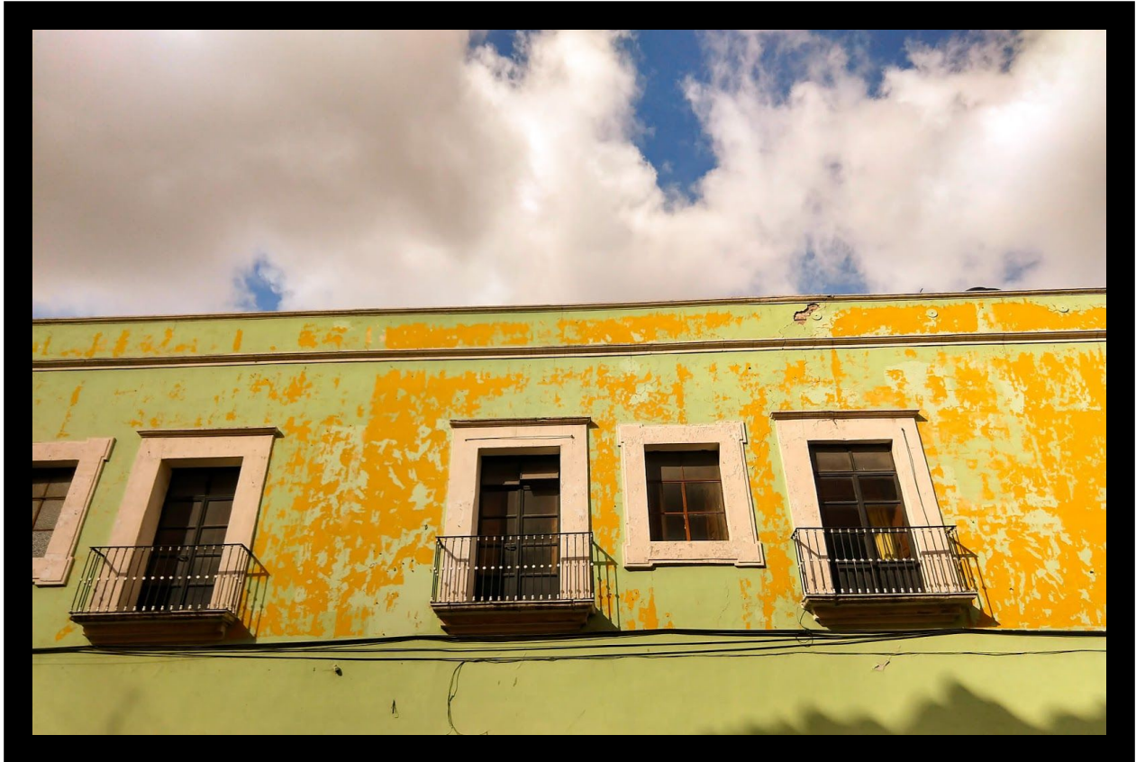
Imagen 38. En esta imagen tomada sobre la avenida 10 poniente, podemos observar la fachada de una antigua casona. Actualmente muchas de las fachadas que se encuentran sobre esta avenida, están en malas condiciones; despintadas, rodeadas de hierbas, con puertas caídas, basura alrededor y muchas de ellas dan la impresión de que están por derrumbarse. Autora: Marina E. Hernández Jaramillo. Puebla, Pue. Junio de 2019. Fotografía tomada con un dispositivo móvil. Coordenadas: 19.047623,- 98195118
