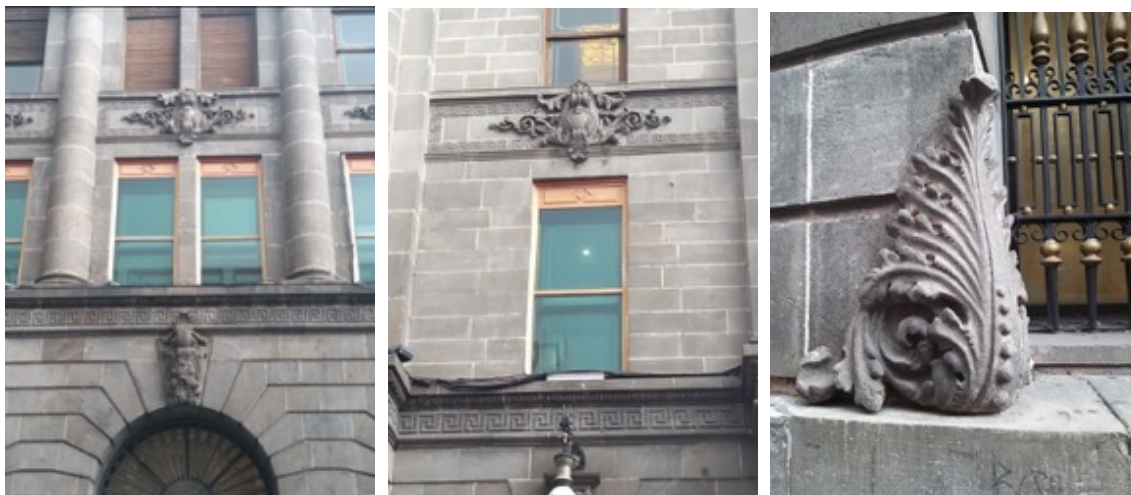
Imágenes X, Y y Z. Juntas rehundidas del primer nivel, friso neoclásico, medallones y elementos ornamentales vegetales del primer y segundo nivel del edificio del Banco Oriental (Fotografías: Ana Martha H. Castillo)
