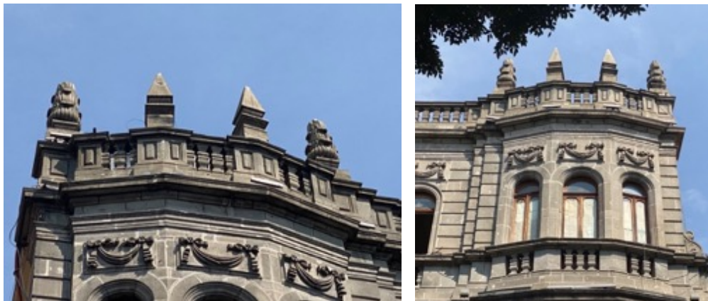
Imágenes 246 y 247. Balaustrada y pináculos que coronan el tercer nivel de la fachada del Palacio Municipal (Fotografías: Ana Martha H. Castillo)
