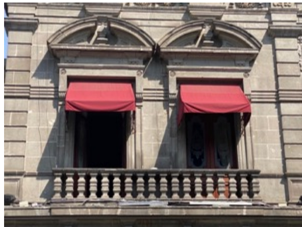
Imágenes 232, 233, 234 y 235. Juntas rehundidas en los tres niveles de la fachada del Palacio Municipal (Fotografías: Ana Martha H. Castillo)
