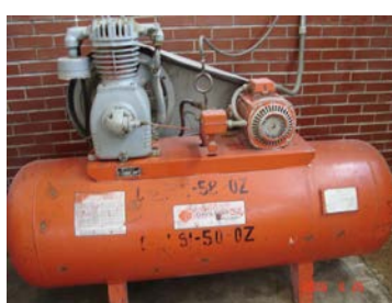
COMPRESOR DE TOLVAS DE HARINA
