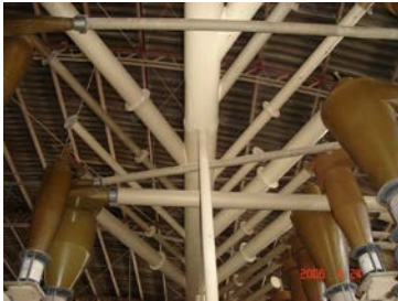
TUBERÍA DE ASPIRACIÓN
