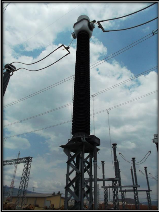
Ilustración 11, 6 Tc's En Bahías de 400kv
