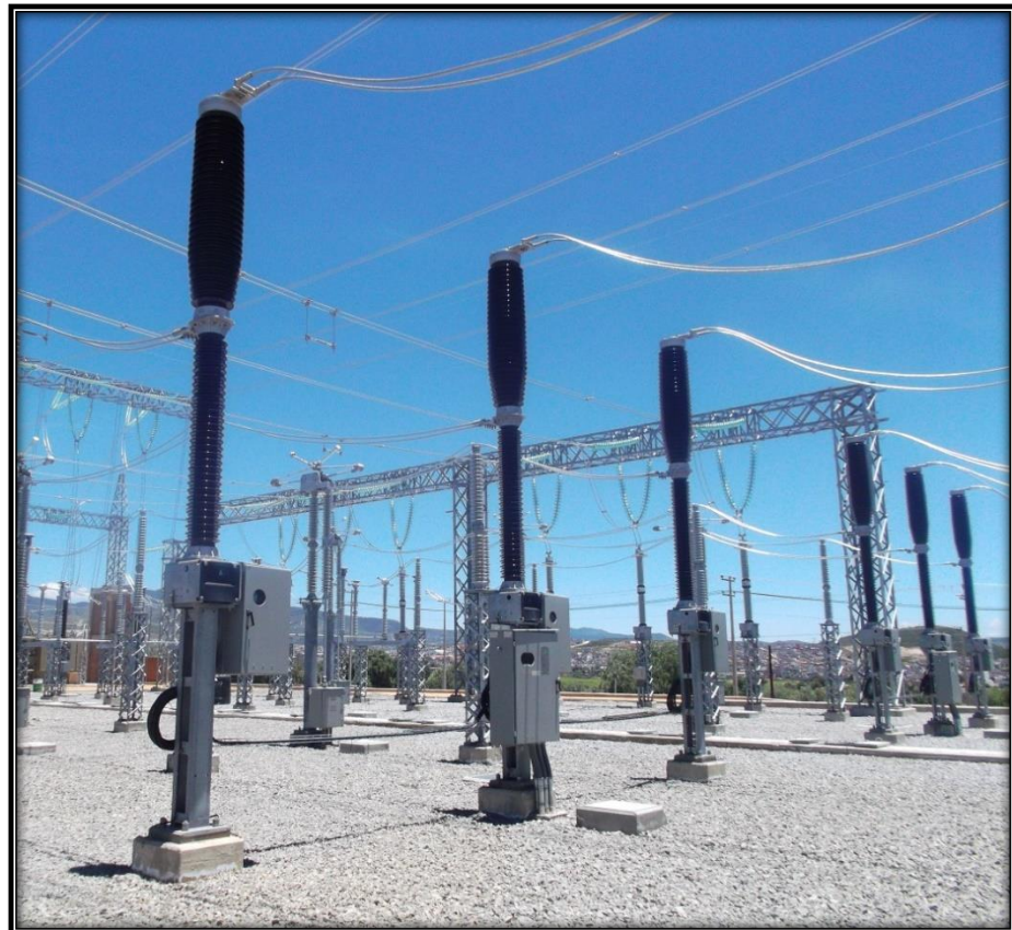
Ilustración 5, 5 Interruptores de potencia en bahías de 230kv
