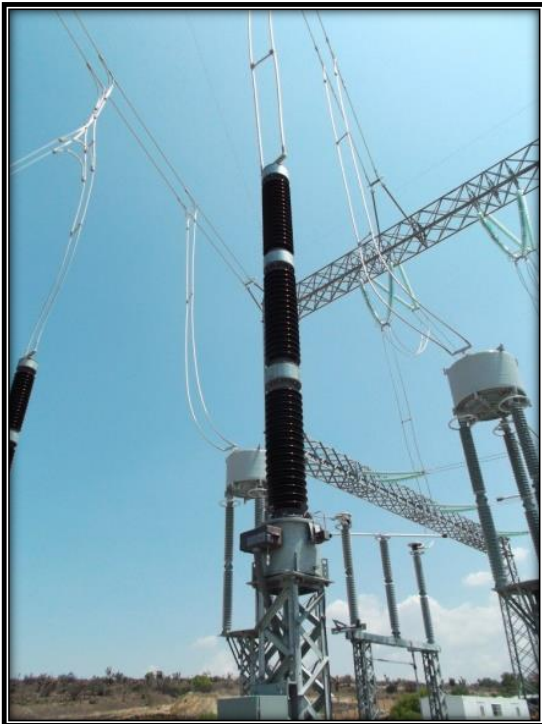
Ilustración 10, 6 TP c en bahías de 400kv
