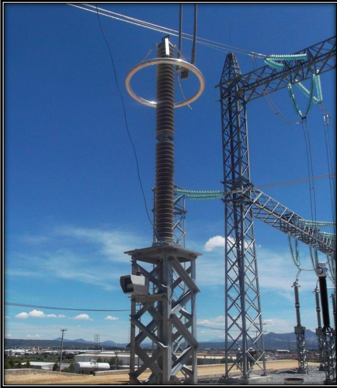
Ilustración 9, Apartarrayos 13 en bahías de 230kv
