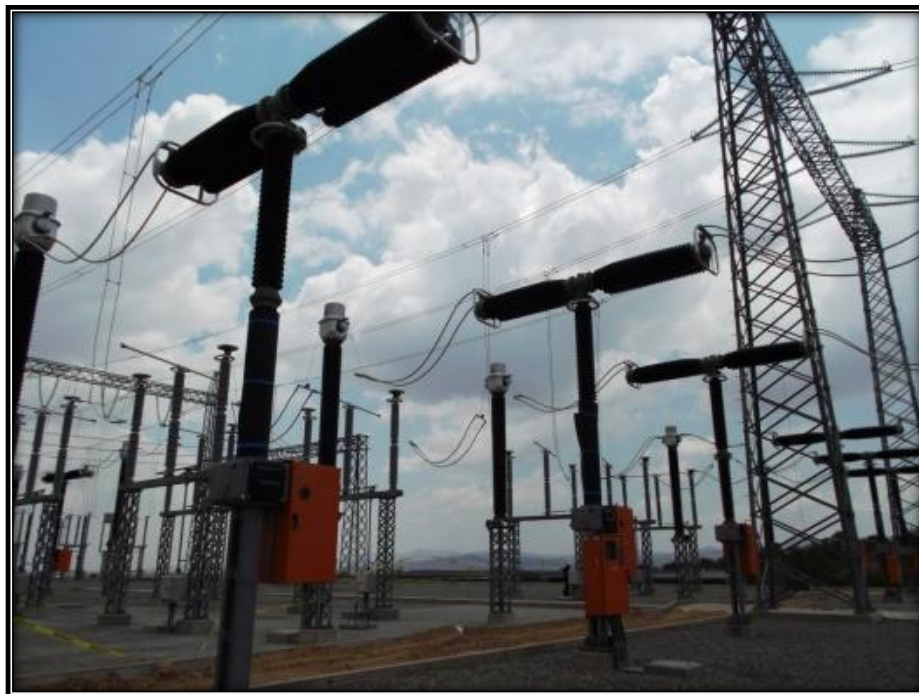
Ilustración 4, Interruptor de potencia tipo “T” 9 en bahías de 400kv
