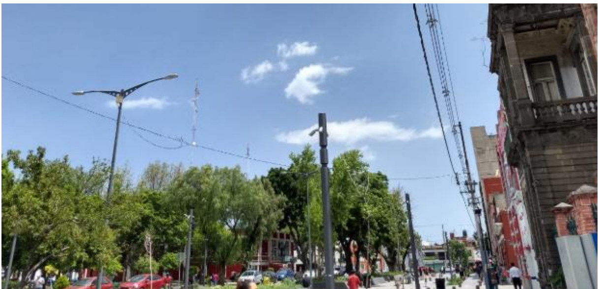
Figura 3. 9 Línea aérea en media tensión existente entre Av. Juárez y 11 Poniente
