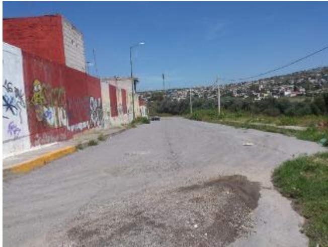
Fotografía 2. Calle Pino Suárez deteriorada que colinda con una barranca. Valencia, octubre 2017.
