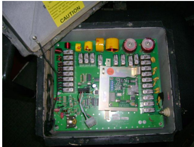
Fig. 5.5 parte interna de la caja de conexiones
