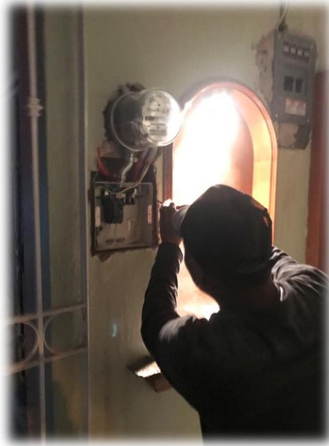
Foto 38 (Hernández, Medidor bidireccional e instalación de equipo de desconexión de SFVI, 2019)
