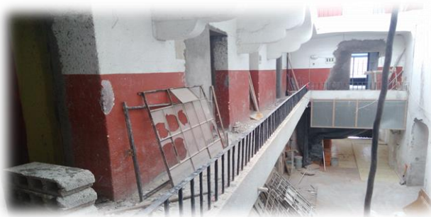
Foto 27. Pasillo en deterioro (Hernández, 2017)
