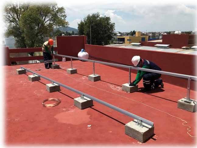
Foto 35. (Hernández, Sistema de Montaje para sistema Fotovoltaico en Cholula, Puebla, 2020)
