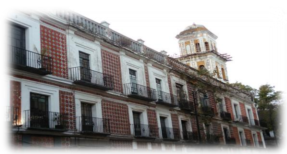
Foto 28. Deterioro total de la cornisa (Hernández, 2017).
