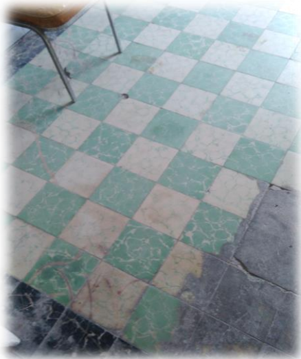
Foto 19. Detalle del tipo de piso en las habitaciones, nótese el nivel de deterioro (Hernández, 2017).
