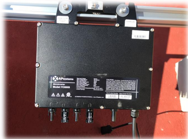
Foto 37. (Hernández, Microinversor para sistema fotovoltaico interconectado a la red, 2020)
