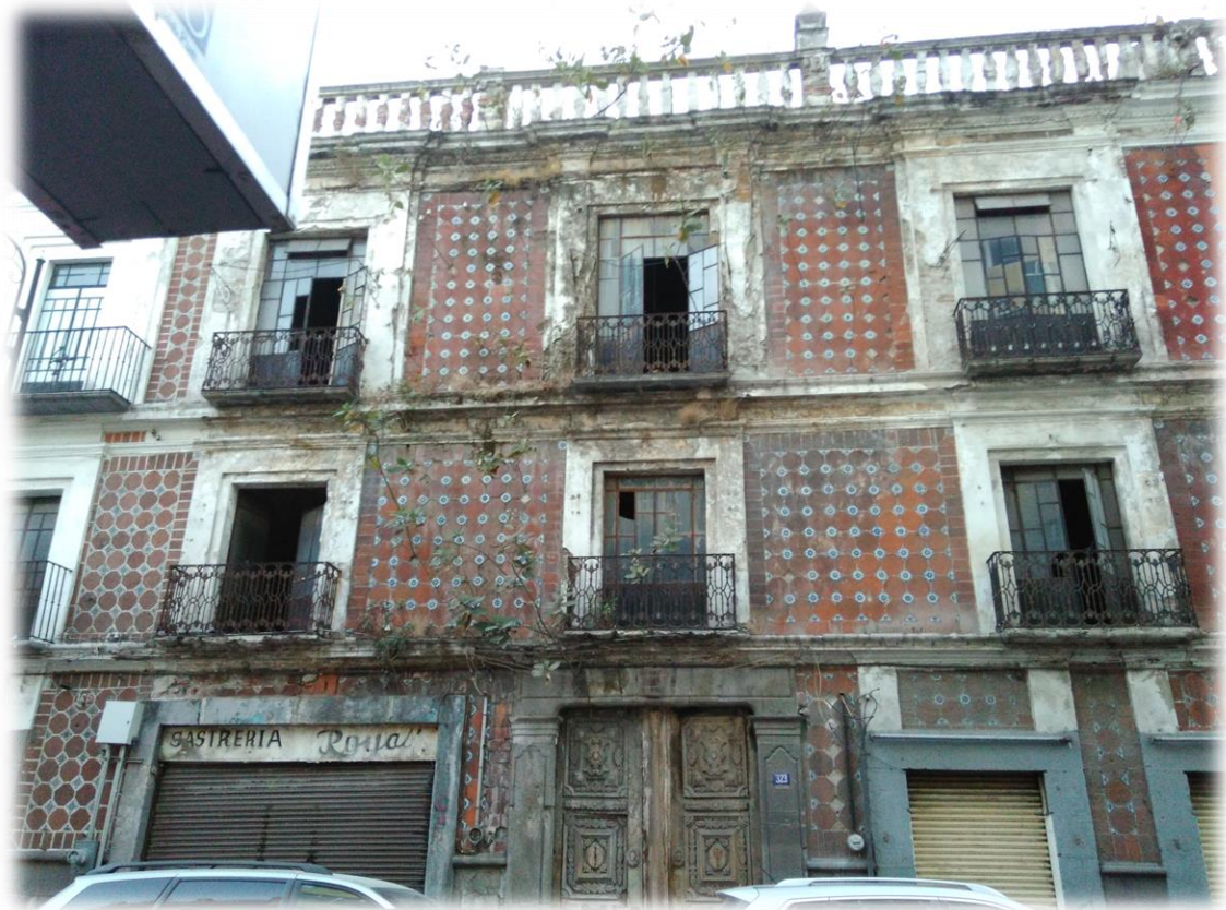
Foto 30. Se aprecia un nivel de deterioro grave en otra parte del inmueble, la cual no se intervendrá (Hernández, 2017).
