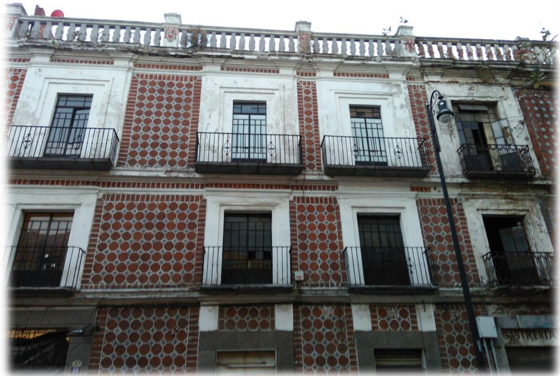
Foto 29. Se aprecia la vegetación y la humedad en los niveles superiores del edificio (Hernández, 2017).
