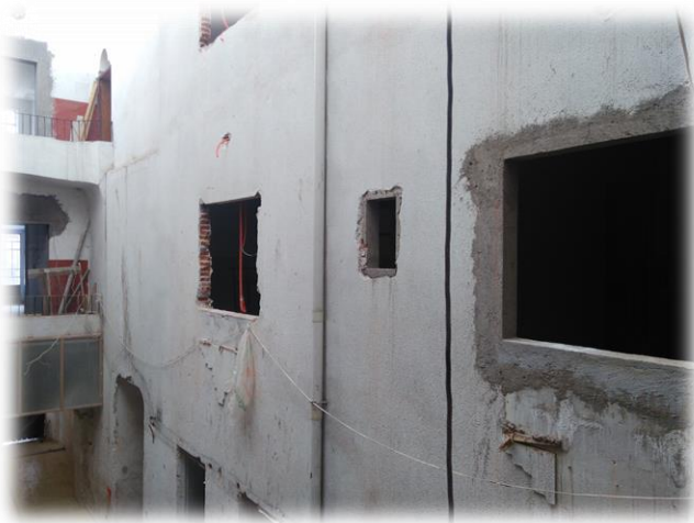
Foto 24. Se muestran las viviendas, pasillos, y el estado en el que quedó el inmueble en su última ocupación (Hernández, 2017).
