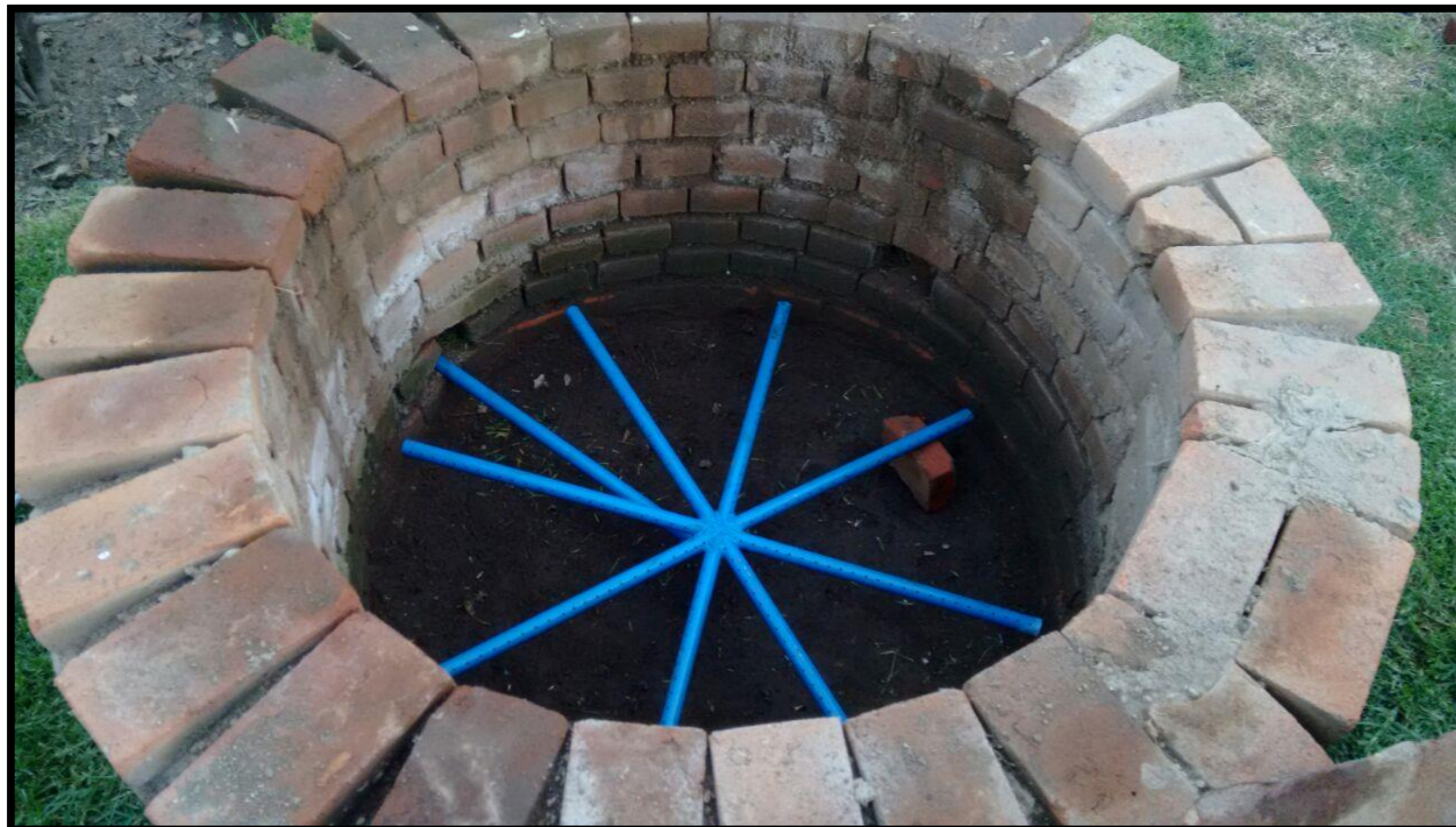
IMAGEN 5.2.13. INSTALACIÓN DE GAS PARA HORNO PRUEBA. (COLECCIÓN PROPIA, 2016)
