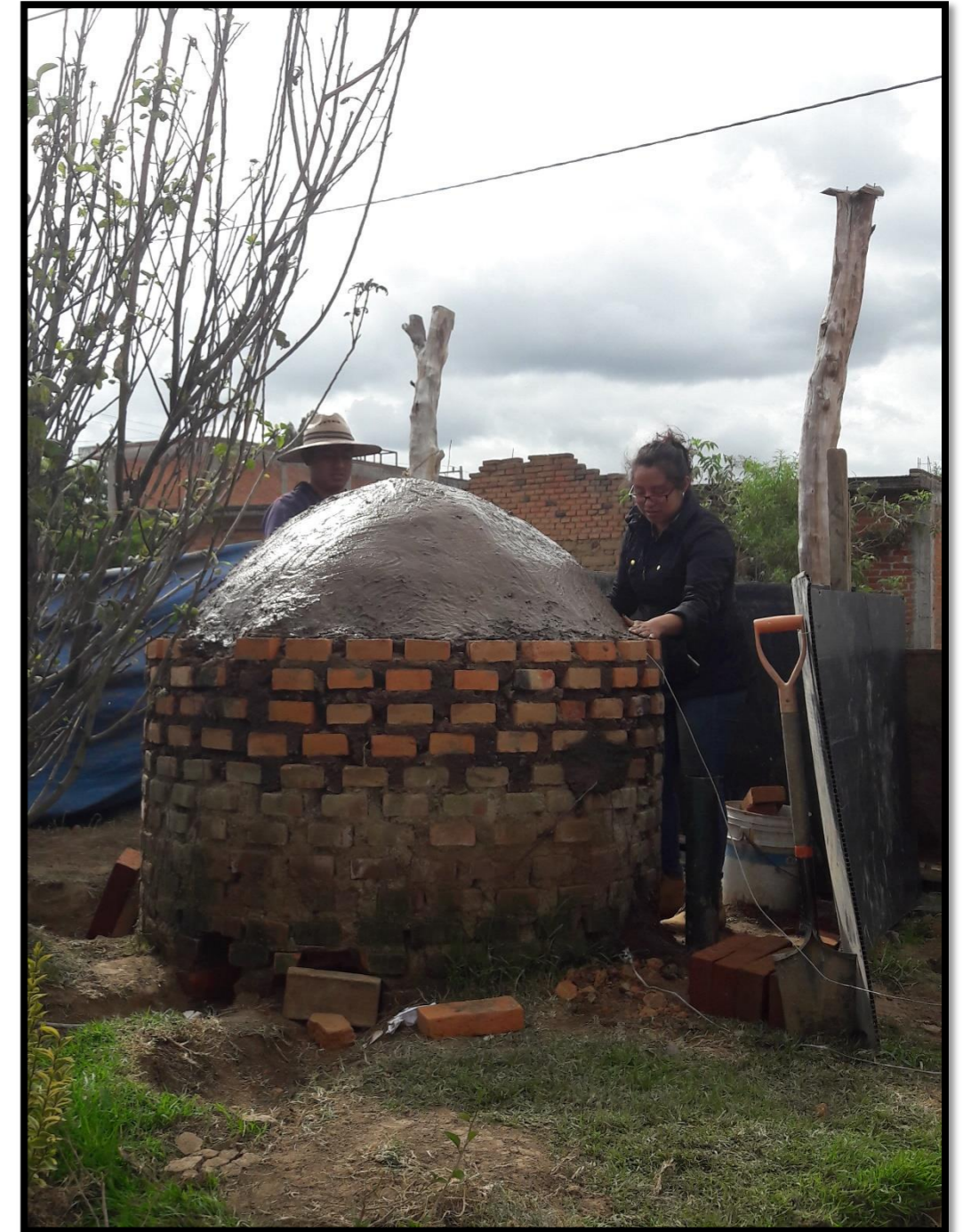
IMAGEN 5.2.29. HORNO EN FUNCIONAMIENTO. (COLECCIÓN PROPIA, 2016)
