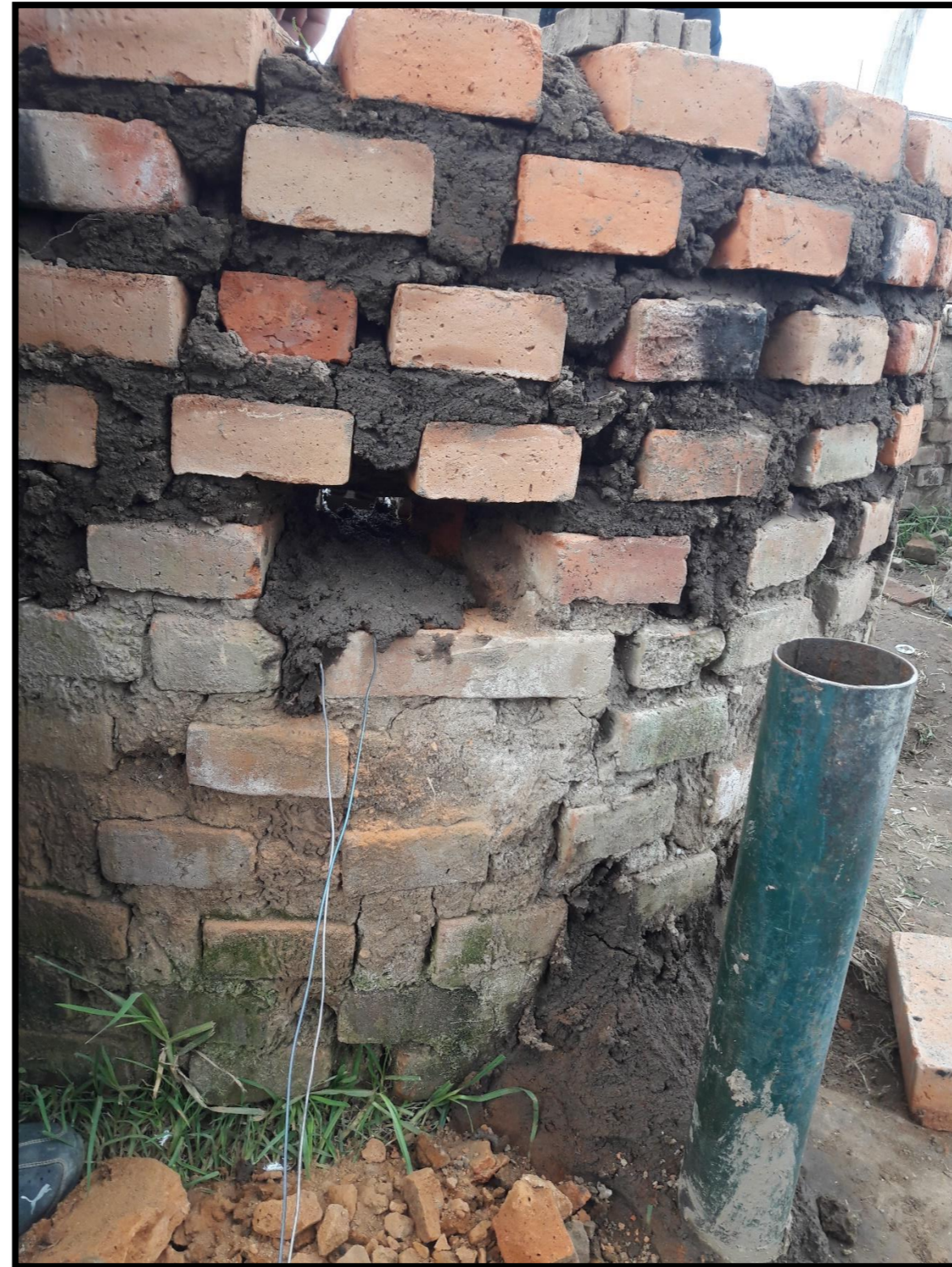
IMAGEN 5.2.16. INSTALACIÓN DE VENTILACIÓN. (COLECCIÓN PROPIA, 2016)
