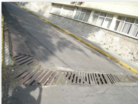
Imagen 138. Vista de alcantarillado deteriorado Contiguo a zona 1
