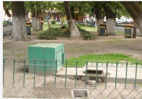
Imagen 209. Vista de infraestructura (cisterna). Ausencia de tapas de registro y cisterna. Zona 3
