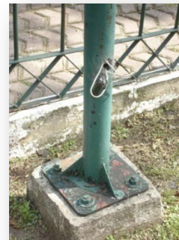
Imagen 179. Vista de mobiliario. Luminarias con falta de mantenimiento, el cableado está expuesto y las bases de postes están oxidados
