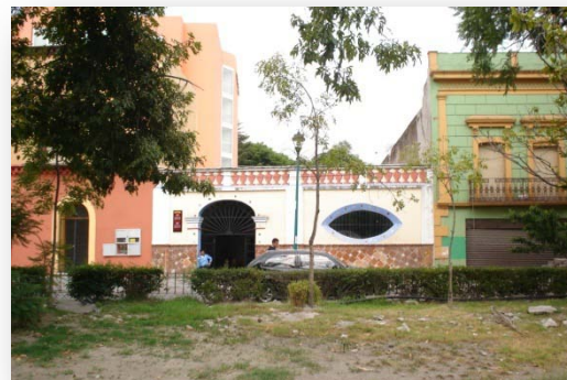
Imagen 278. Vista de fachada a dar mantenimiento, pintar fachada y resanar muros, Antiguos Lavaderos de Almoloya e inmueble contiguo abandonado. Zona 4
