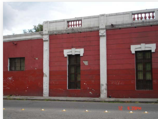
Imagen 270. Vista de inmueble antiguo en deterioro y con grafitis, Casa de Esteban de Antuñano, ubicado en el contexto de Zona 1
