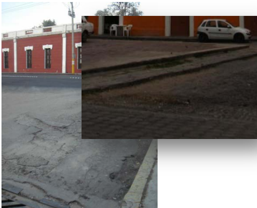
Imagen 323. Vista del estado actual de vialidad vehicular en el Parque.
