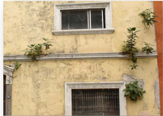
Imagen 276. Vista de fachada a dar mantenimiento, retirar vegetación nociva, restaurar y pintar fachada.
