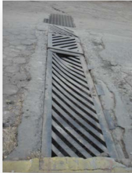
Imagen 202. Vista de infraestructura (alcantarillado en deterioro). Zona 2
