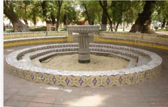
Imagen 312. Vista del estado actual de la Fuente circular de azulejo, erigida al poeta Rafael Cabrera, está en deterioro excesivo y con grafiti de pintura en aerosol, no funciona, está ubicada en la zona 3
