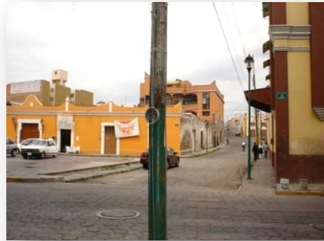
Imagen 141. Vista de red de electricidad y tapa de registro red de drenaje. Contiguo a zona 2
