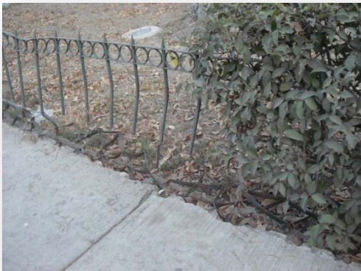
Imagen 279. Vista de valla deteriorada, existente en áreas verdes de acceso restringido en el Parque.
