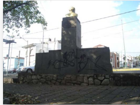
Imagen 167. Vista posterior de mobiliario. Monumento a Manuel María Flores con daños por pintura y deterioro en su estructura, ubicado en zona 1
