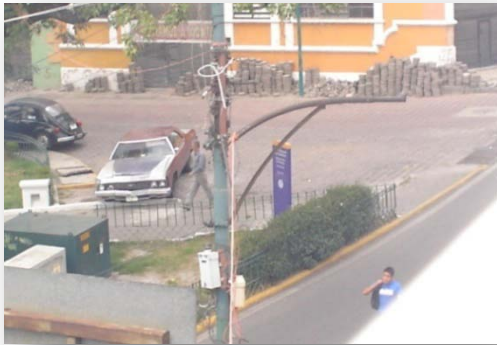
Imagen 144. Vista de cableado de red de electricidad en mal estado. Contiguo a zona 4
