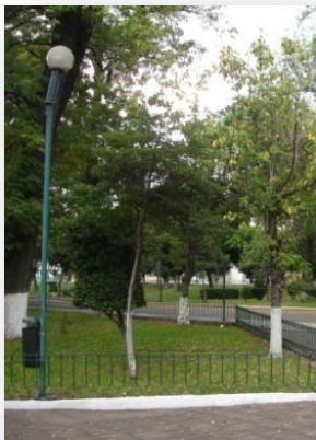
Imagen 296. Vista de mobiliario de servicio de iluminación existente en el interior del Parque.
