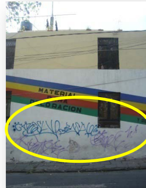
Imagen 268. Vista lateral de inmuebles del contexto con deterioros y grafitis en muros. Zona 1
