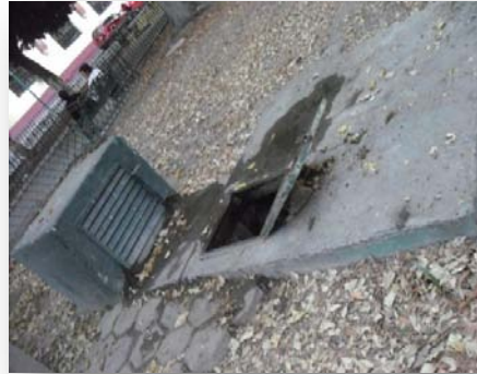
Imagen 207. Vista de infraestructura (cisterna abierta y carente de vigilancia y mantenimiento). Zona 3
