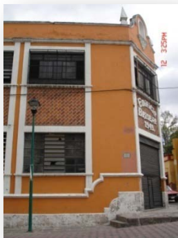
Imagen 277. Vista de fachada a dar mantenimiento, resanar muros, pintar fachada reemplazar vanos, inmueble abandonado Edificio Briseño. Zona 4
