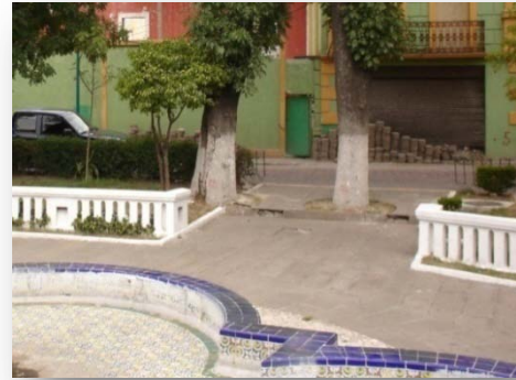
Imagen 195. Vista de vialidad peatonal y vehicular en deterioro. Zona 4
