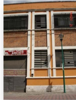
Imagen 109. Vista de deterioros de fachada del edificio Briseño.
