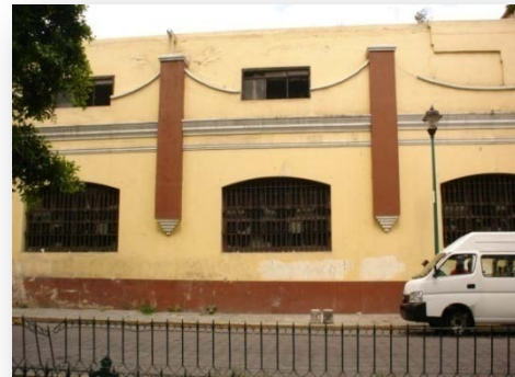
Imagen 107. Vista de deterioros en fachada y elementos arquitectónicos de inmueble antiguo
