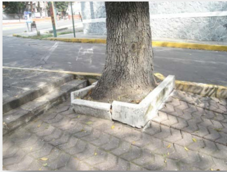
Imagen 281. Vista de alcorque / arriate deteriorado en el Parque.
