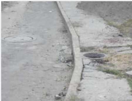
Imagen 204. Vista de infraestructura (fractura en materiales y boca de tormenta sin tapa). Zona 2
