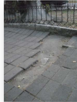
Imagen 193. Vista de vialidad peatonal y fracturas en piso. Zona 3
