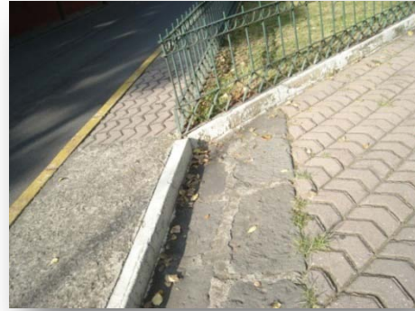
Imagen 189. Vista de vialidad peatonal. Deterioro y uso de diferentes materiales, falta de accesibilidad y mantenimiento. Zona 1
