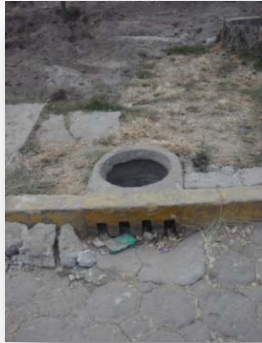
Imagen 206. Vista de infraestructura (alcantarillado, boca de tormenta con fractura y sin tapa). Zona 3
