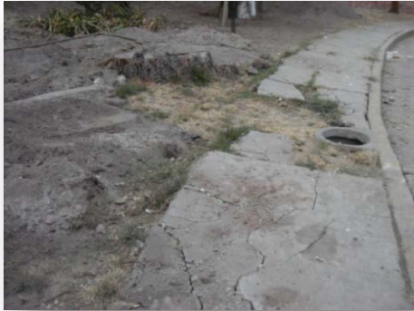
Imagen 192. Vista de vialidad peatonal y deterioros severos. Zona 3
