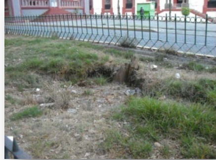
Imagen 50. Vista de área verde sin mantenimiento. Zona 2
