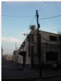
Imagen 142. Vista de cableado de red de electricidad y telefonía con falta de mantenimiento. Contiguo a zona 3
