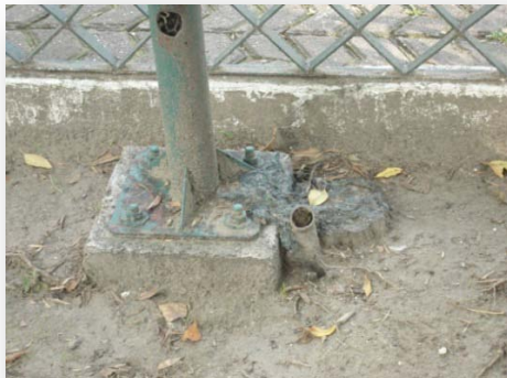
Imagen 200. Vista de infraestructura (red de electricidad deteriorada). Zona 1
