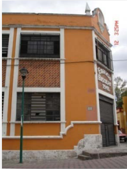
Imagen 108. Vista lateral de edificio Briseño (1949). Inmueble antiguo en proceso de deterioro, contiguo a zona 4.
