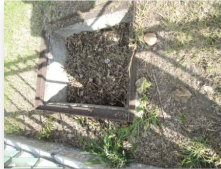
Imagen 199. Vista de infraestructura (Red sin tapa en registro). Zona 1
