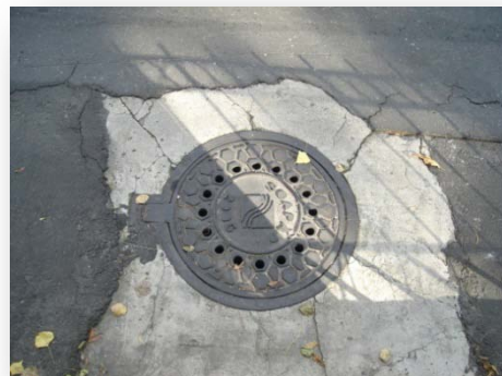
Imagen 139. Vista de tapa de registro red de agua potable y pavimento deteriorado.
