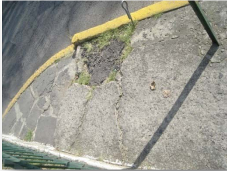
Imagen 188. Vista de vialidad peatonal. Deterioro y diferentes materiales, sin rampas de acceso ni señalamiento para cruce peatonal.
