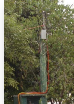
Imagen 211. Vista de infraestructura (cableado enredado y expuesto a intemperie). Zona 4
