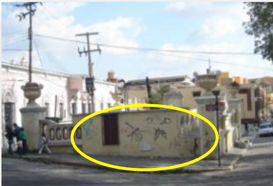
Imagen 273. Vista de estructura para bombas de agua, se propone dar mantenimiento, resanar y pintar fachada. Zona 2
