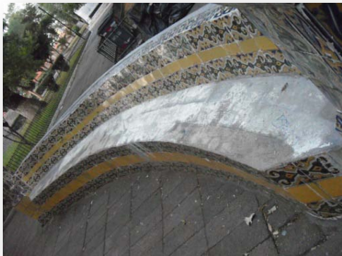
Imagen 160. Vista de mobiliario de descanso deteriorado, ubicado en el interior de la zona 3 del Parque.
