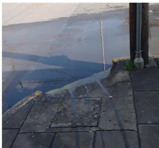
Figura 2.13.2.5.- Esquina 15 sur y 15 poniente. Se observa banqueta tipo lajas de piedra y una rampa en esquina que genera encharcamientos. Fuente: Archivo Fotográfico propio.
