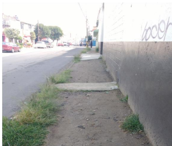
Figura 2.13.2.3 Estado actual de la acera que se encuentra identificada sobre la calle 17 sur, entre las avenidas 21 y 23 poniente. Fuente: Elaboración propia.
