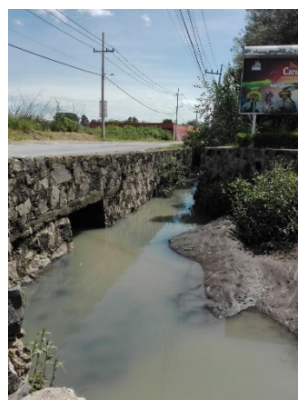
Foto 24: Descarga de aguas negras.
