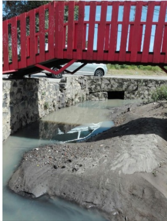
Foto 21: Desgaste del suelo por corriente de agua.
