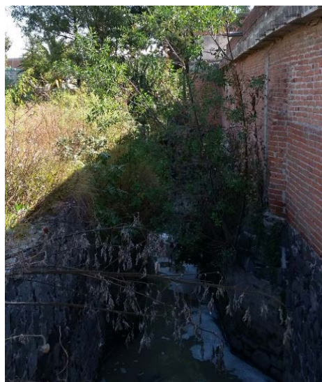
Foto 2: Barranca La Uranga, Chautenco. Construcción invadiendo zona federal de la barranca.
