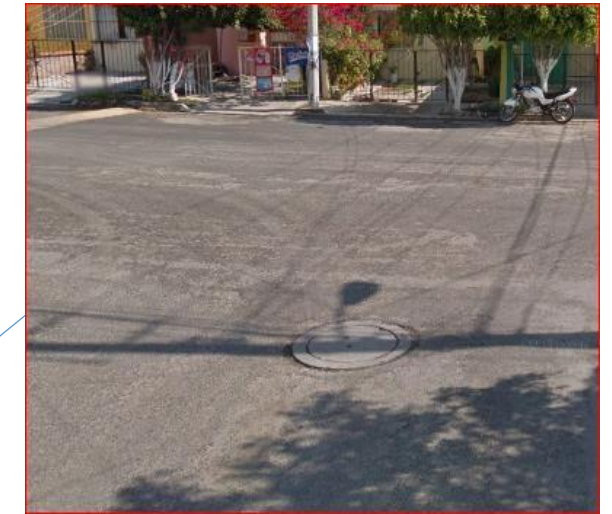
Pozo de Visita
