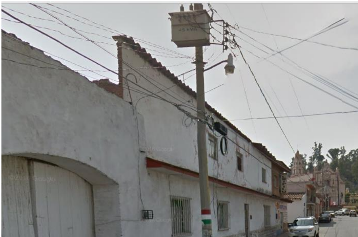
IMAGEN 16. Transformador 45 kva 3F – 4H, Chipilo de Francisco Javier Mina.
