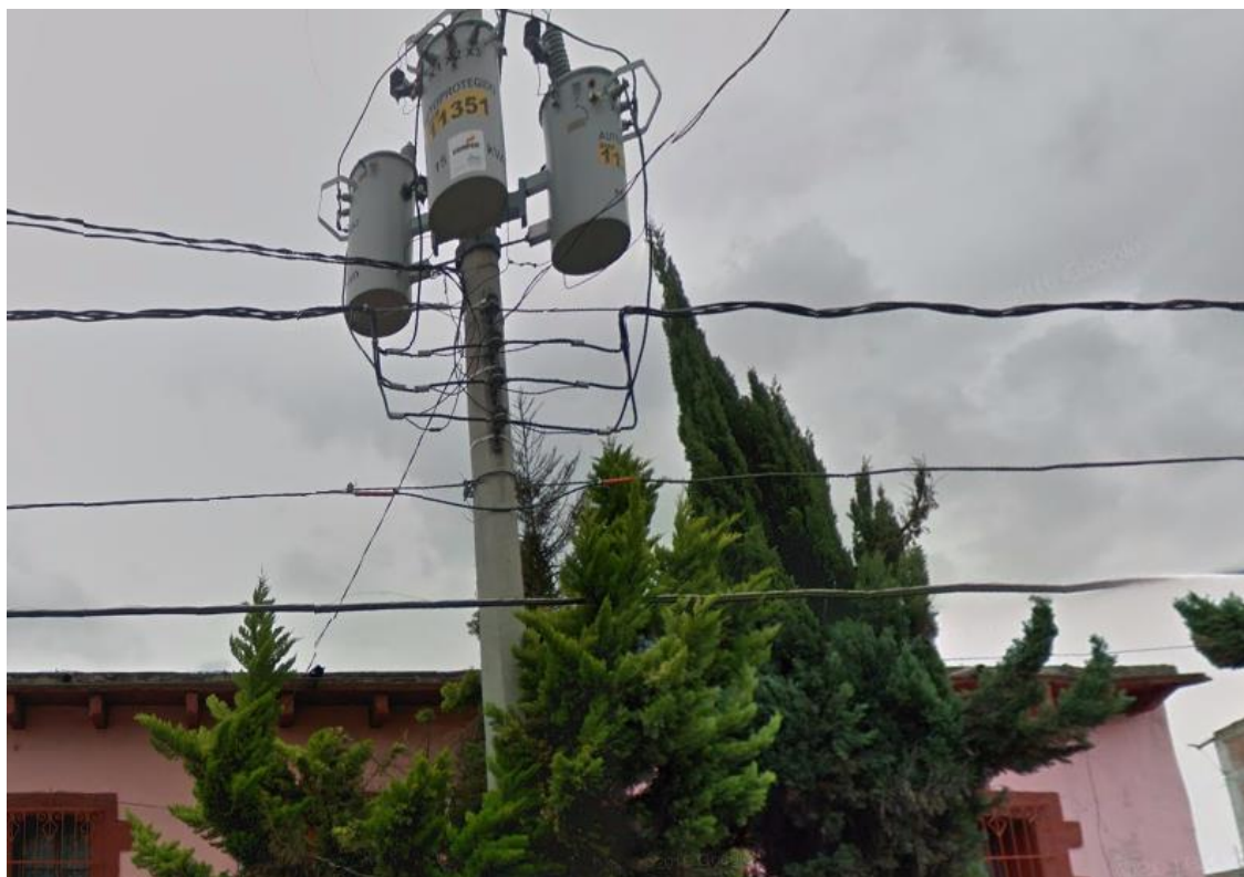
IMAGEN 15. Transformador 15 kva 1F – 3H, Chipilo de Francisco Javier Mina.
