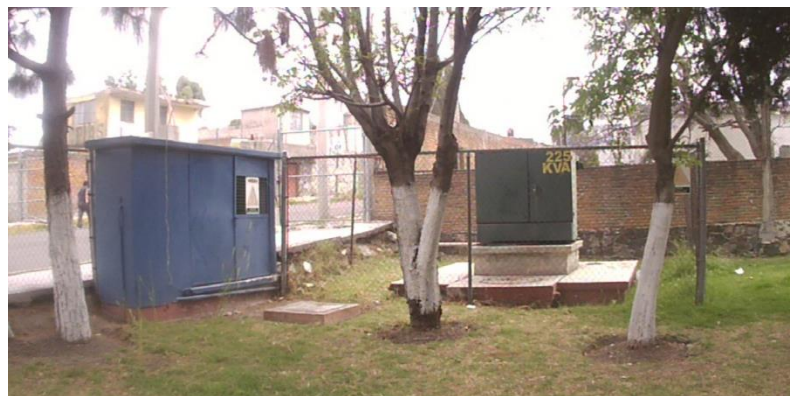
Imagen Infraestructura energética vista de mobiliario eléctrico interior del terreno Fotografía Martha de la Villa Casillas
