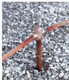
Fig. 14: Los sistemas de conexión a tierra de cobre desnudo trenzado conectado a varillas de tierra.
