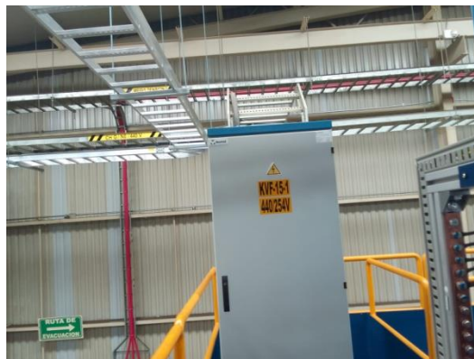
Fig. 50: Panel de alimentación principal.
