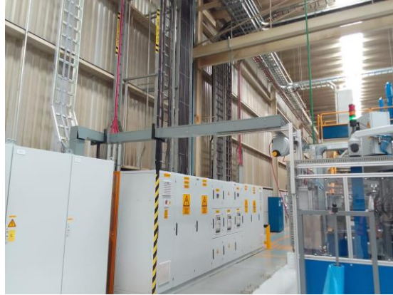
Fig. 53: Panel de control principal y tablero de alimentación eléctrica.
