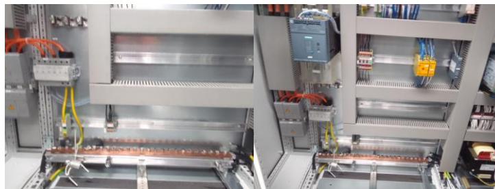
Fig. 48: Panel de fuerza eléctrica.
