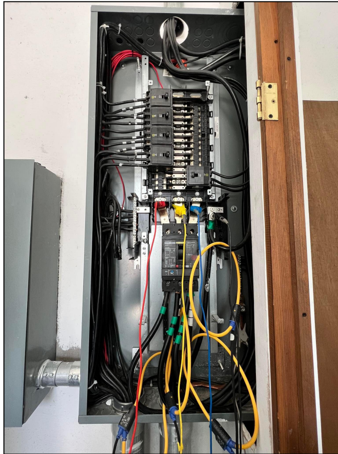
Figura 2.2: Conexión del analizador al tablero principal del FCE5 [Captura propia]
