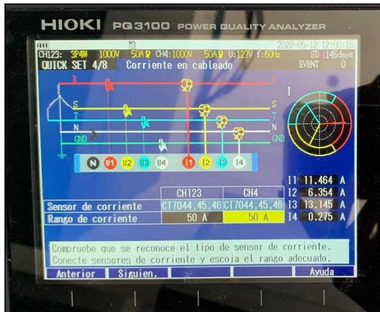
Figura 2.5: Señalización de conexión del analizador de calidad de la energía [Captura propia]
