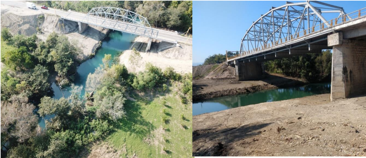
Figura 4. Puente COY antes de los trabajos de modernización. (Fotografías de los reportes del proyecto)
