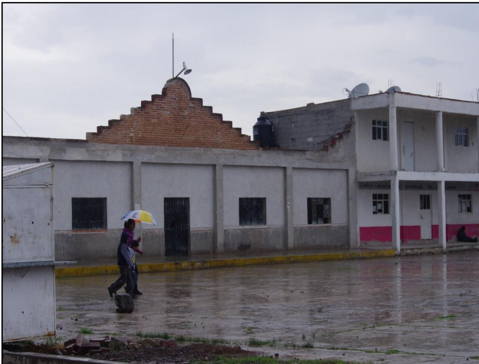
Fotografía 10. Se observa la Presidencia de la junta auxiliar un en obra negra, y como el factor ambiental poco a poco deteriora la estructura. (Fuente propia).
