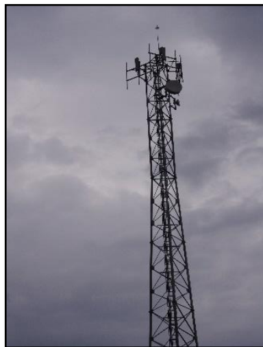
Fotografía 8. Antena de la empresa telefónica Movistar (fuente propia).
