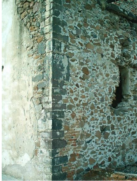
Fig. 67. Xalnene en esquinas de torre campanario
