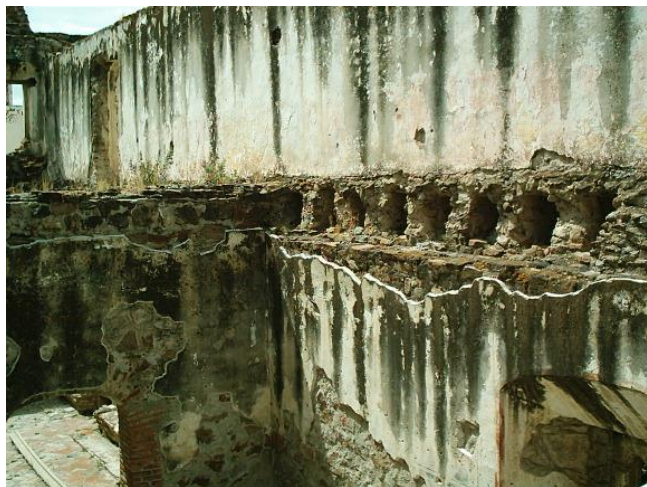
Fig. 62. Vacio en apoyos de techo que se derrumbo
