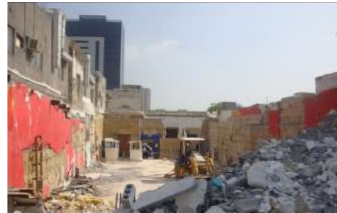
Ilustración 23 Interior del predio P. Mier #850 oriente. Demoliciones al 24 de julio 2014 Fuente: agresionespatrimoniosigloxxblogspot
