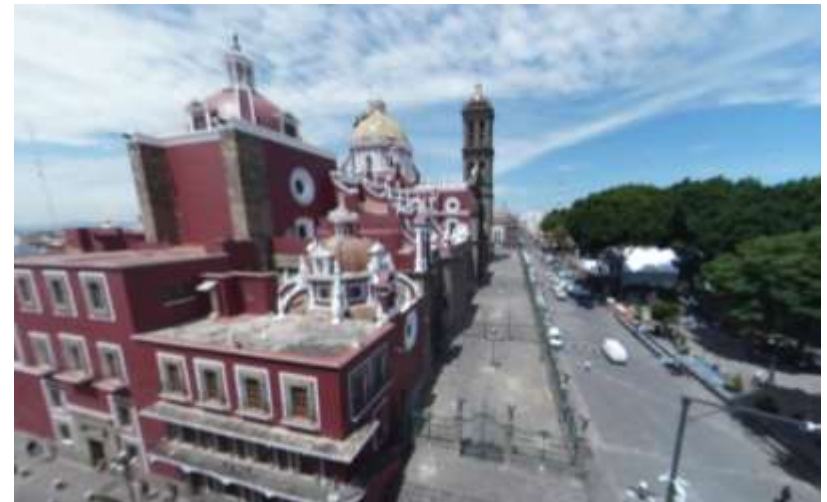
Ilustración 129 Vista posterior de la Catedral de Puebla con linternilla colapsada. Fuente: E.P.P. 20 Sep. 2017
