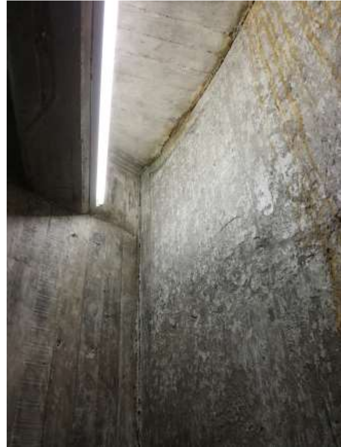
Ilustración 137 Separación de losa de planta alta del silo 2. Fuente: E.P.P. 2 Oct. 2017
