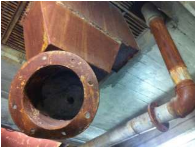
Ilustración 63. Tolva localizada en el silo 2 de la ex fábrica Cementos Atoyac. Fuente: E.P.P. diciembre 2015
