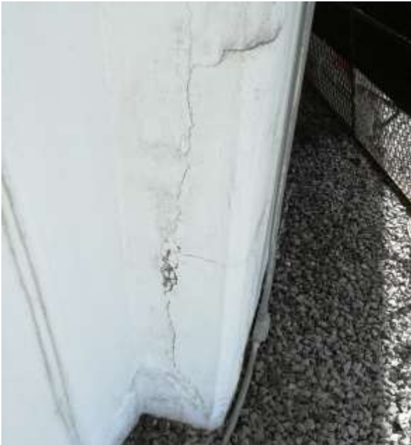
Ilustración 136 Grieta en columna del silo 1. Fuente: E.P.P. 2 Oct. 2017
