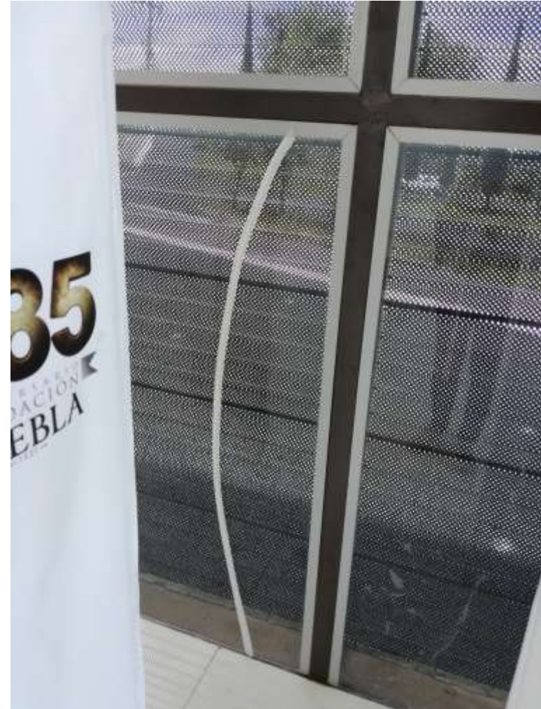
Ilustración 135 Vidrio roto en Fachada Sur del Lobby. Fuente: E.P.P. 2 Oct. 2017
