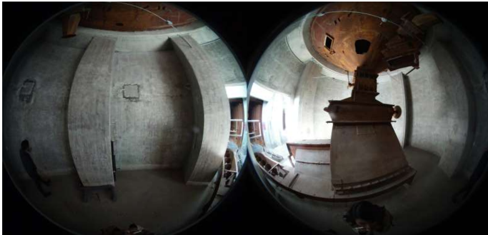
Ilustración 138 Fotografía esférica en supervisión post- sismo en silo 1 planta alta. Fuente: E.P.P. 2015
