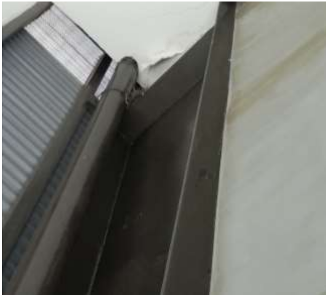
Ilustración 134 Desprendimiento por humedad en esquina sur-poniente del Lobby. Fuente: E.P.P. 2 Oct. 2017
