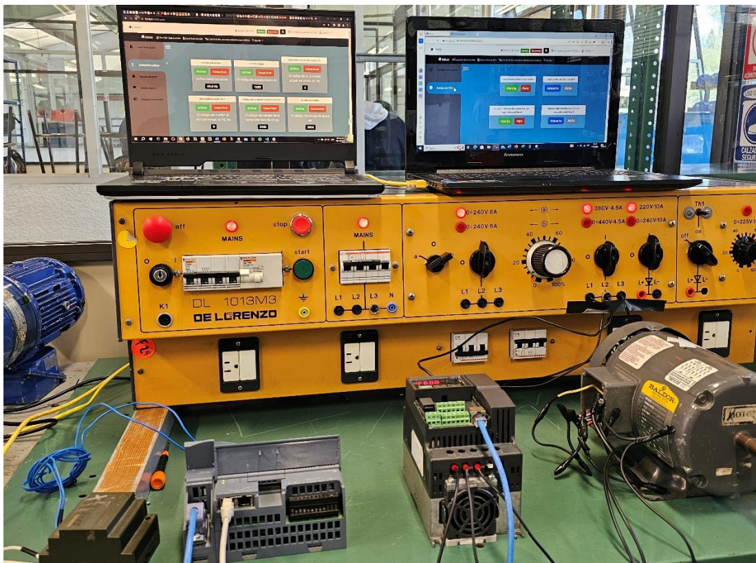
Figura 4.48: Proceso industrial en operación.
