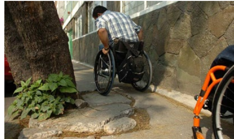
Figura 3.1. Imagen de ejemplo de barrera urbana de riesgo medio, raíces expuestas de árboles y pavimento en mal estado. Fotografía propia (2018).
