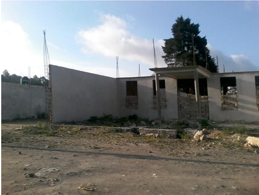
Reporte fotográfico 2014, Atempan-Teziutlán, Edo. Puebla. Las imágenes muestran los nuevos modelos de vivienda que se está edificando en la región.
