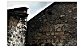
F04. Desprendimiento de aplastados en muro fachada oriente
