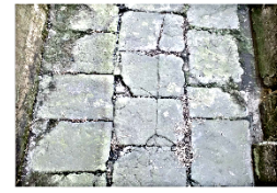
F02. Pérdida de material en piso exterior del espacio (Andador Exterior)
