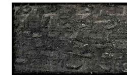
F08. Desagrietamiento de pintura, humedad y graffiti en muro interior de la Base del tanque de agua.
