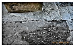
F05. Presencia de humedad en piso al interior de la Base del tanque de agua.
