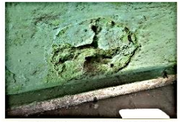
P07. Desprendimiento de aplastados y pérdida de material en muro interior oriente en la Sala de espera
