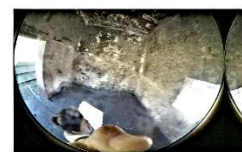
F03. Presencia de humedad en piso al interior del Cuarto de Aceites.
