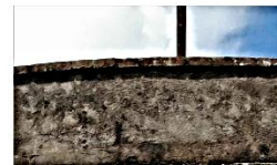
F05. Desagrietamiento de pintura en muro al interior de la Base del tanque de agua.
