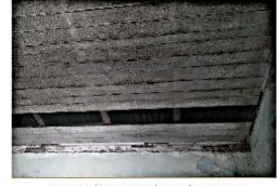
P05. Pérdida de material en ciclo raso en cubierta interior en Casa del Agente (primera sección)
