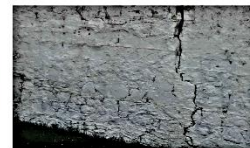
F02. Grieta longitudinal en muro fachada oriente
