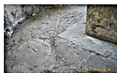
F04. Disgregación de material de piso al interior de la Base del tanque de agua.
