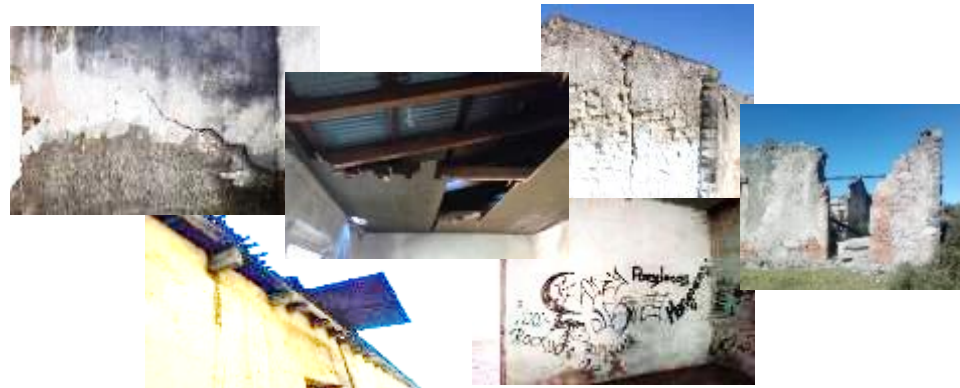
Fig. 02. Luna Mayoral, N. (2020). Grieta multidireccional en muro casa de sección, y sustracción de madera de la Estación de Boca del Monte. [Recopilación de Fotografías]. Fuente: Equipo de Trabajo Maestría de Conservación del Patrimonio Edificado FABUAP.
