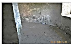
F03. Disgregación de material de piso al interior de la Base del tanque de agua.
