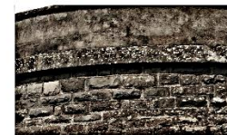
F03. Presencia de humedad y graffiti en muro al interior de la Base del tanque de agua.
