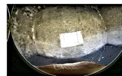
F05. Presencia de humedad en piso al interior del Cuarto de Aceites.
