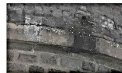
F09. Presencia de humedad en columna al interior de la Base del tanque de agua.
