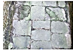
F04. Presencia de microorganismos (hongos) en piso exterior del espacio (Andador exterior)
