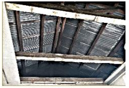
P10. Disgregación de material en vigas de madera de estructura de cubierta al interior en Sala de espera
