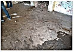
F02. Pérdida de material en piso interior del espacio (Taquilla. Área administrativa)
