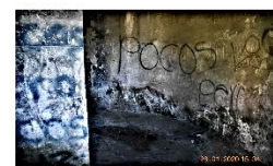
F08. Desprendimiento de pintura, humedad y graffiti en muro interior de la Base del tanque de agua.
