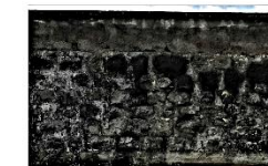
F12. Humedad en muro interior de la Base del tanque de agua.
