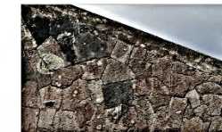
F08. Humedad en muro fachada poniente
