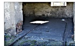
F01. Presencia de corrosión en piso al interior del Cuarto de Aceites.
