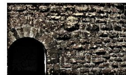
F02. Graffiti en columna al interior de la Base del tanque de agua.
