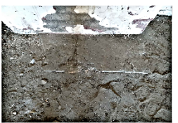
F02. Pérdida de material en piso interior del espacio (Comedor)
