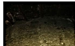
F10. Presencia de humedad en columna al interior de la Base del tanque de agua.
