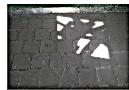
F01. Disgregación de material en piso interior del espacio (Casa del Agente 2)
