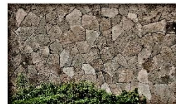
F05. Grieta longitudinal en muro fachada poniente
