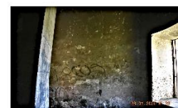
F07. Presencia de humedad y graffiti en muro al interior de la Base del tanque de agua.
