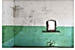
P08. Presencia de humedad y grafiti en muro interior oriente en Sala de espera
