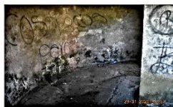
F01. Presencia de humedad en piso interior de la Base del tanque de agua.
