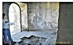
F02. Pérdida de material constructivo en piso al interior de la Base del tanque de agua.
