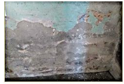
P02. Presencia de humedad y de microorganismos (hongos) en muro interior oriente en Casa del Agente (primera sección)
