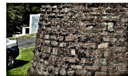
F01. Presencia de humedad en muro interior de la Base del tanque de agua.
