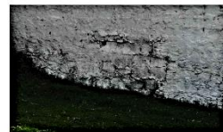
F01. Pérdida de material en muro fachada oriente
