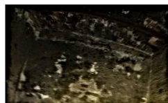
F05. Desprendimiento de pintura en muro al interior de la Base del tanque de agua.
