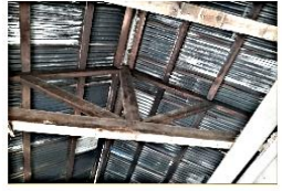
P11. Presencia de humedad en vigas de madera en estructura de cubierta en Sala de espera
