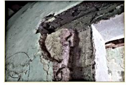
P04. Desprendimiento de aplastados y pérdida de material en muro interior oriente en Casa del Agente (primera sección)
