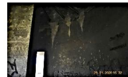
F04. Presencia de humedad en muro al interior de la Base del tanque de agua.
