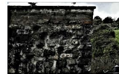
F11. Humedad en muro interior de la Base del tanque de agua.
