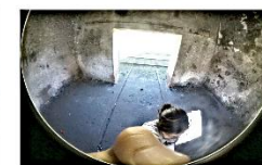
F04. Disgregación del material en piso interior del Cuarto de Aceites.
