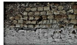
F03. Diagregación de material en muro fachada oriente
