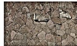
F06. Pérdida de material en muro fachada poniente
