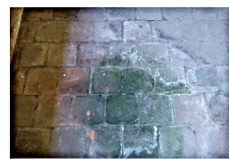
F03. Presencia de humedad en piso interior del espacio (Casa del Agente 1)
