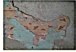
P03. Pérdida de pintura en muro interior oriente en Casa del Agente (primera sección)
