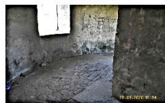
F06. Disgregación de material constructivo en piso de la Base del tanque de agua.
