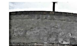
F10. Humedad en muro interior de la Base del tanque de agua.
