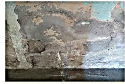
P01. Disgregación de material y presencia de eflorescencia en muro oriente interior en Casa del Agente (primera sección)
