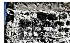
F07. Presencia de humedad y graffiti en muro al interior del de la Base del tanque de agua.
