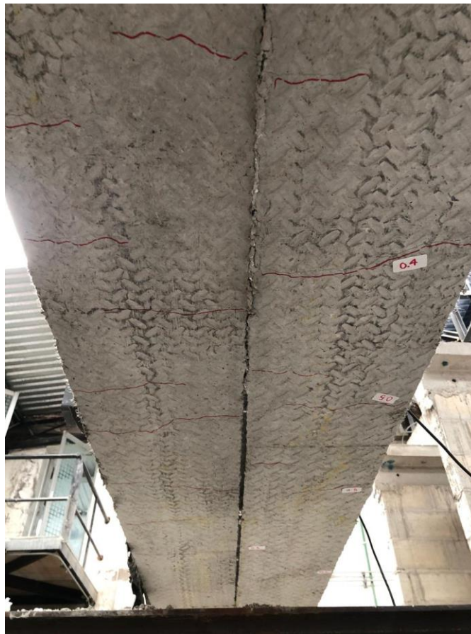
Figura 4-5 Condiciones iniciales de L4-3CV-H18 (fisuras)
