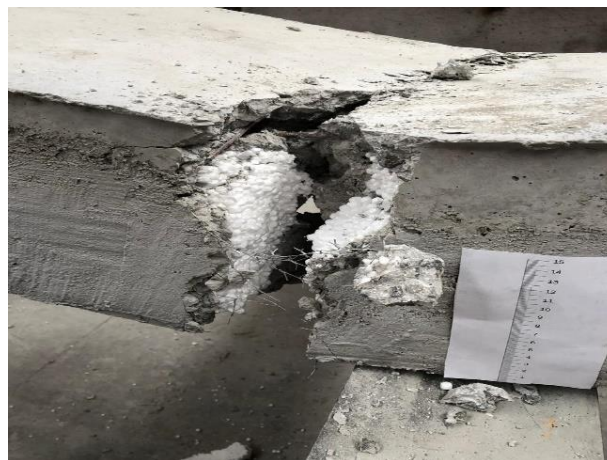
Figura 4-10 Condición final de colapso de L4-3CV-H3
