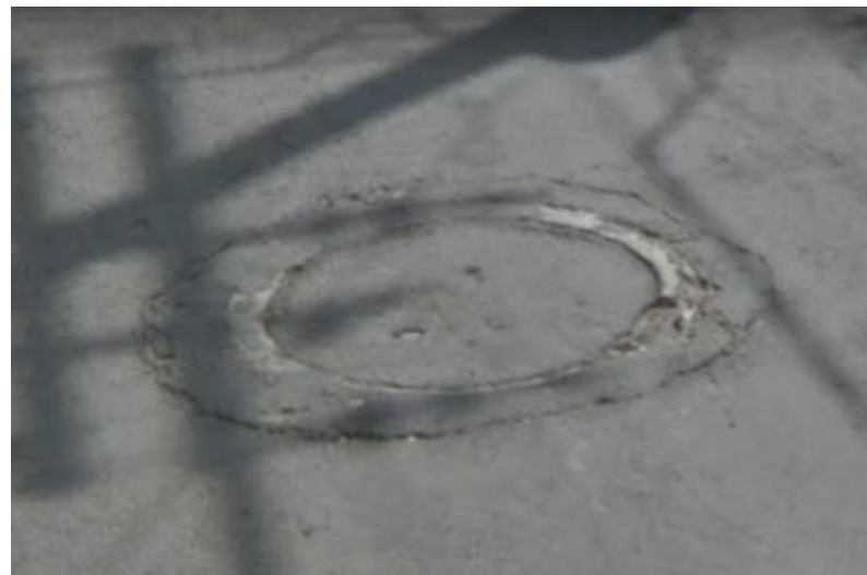
Ilustración 15 Pozo de visita en intersección de Av. De la Reforma y 2 Sur.
