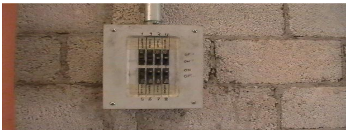
Fig. 1.7 Centro de alumbrado
