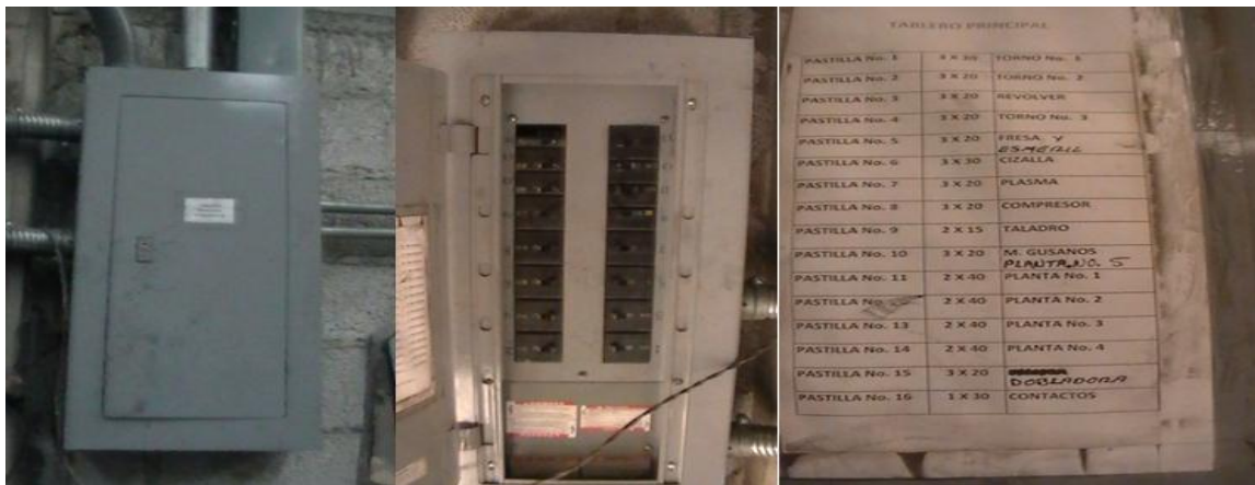
Fig. 1.5 Centro de carga Grupo de motores 1
