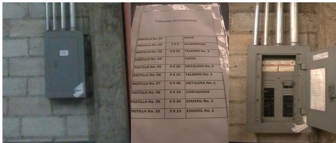
Fig. 1.6 Centro de Carga grupo de motores 2
