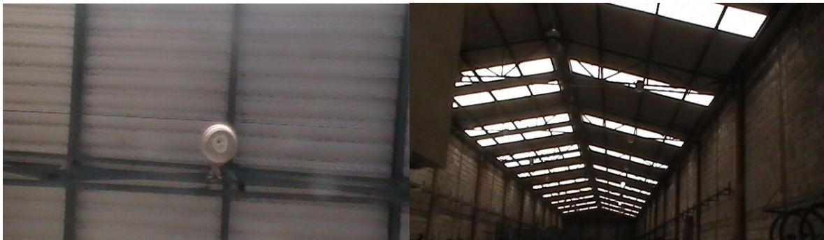
Fig. 1.33 Alumbrados, focos ahorradores de 60 watts
