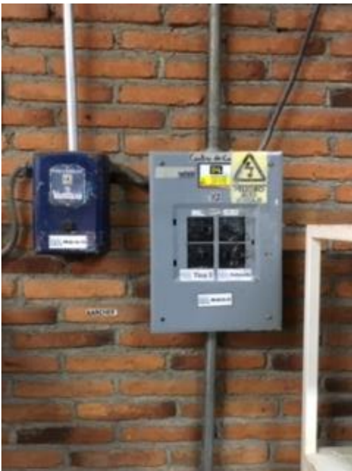
Ilustración 14. Variador y centro de carga de tina 3
