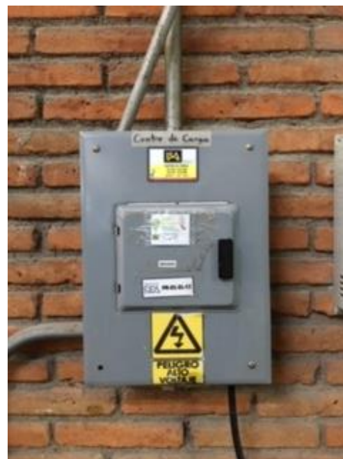
Ilustración 17. Centro de carga
