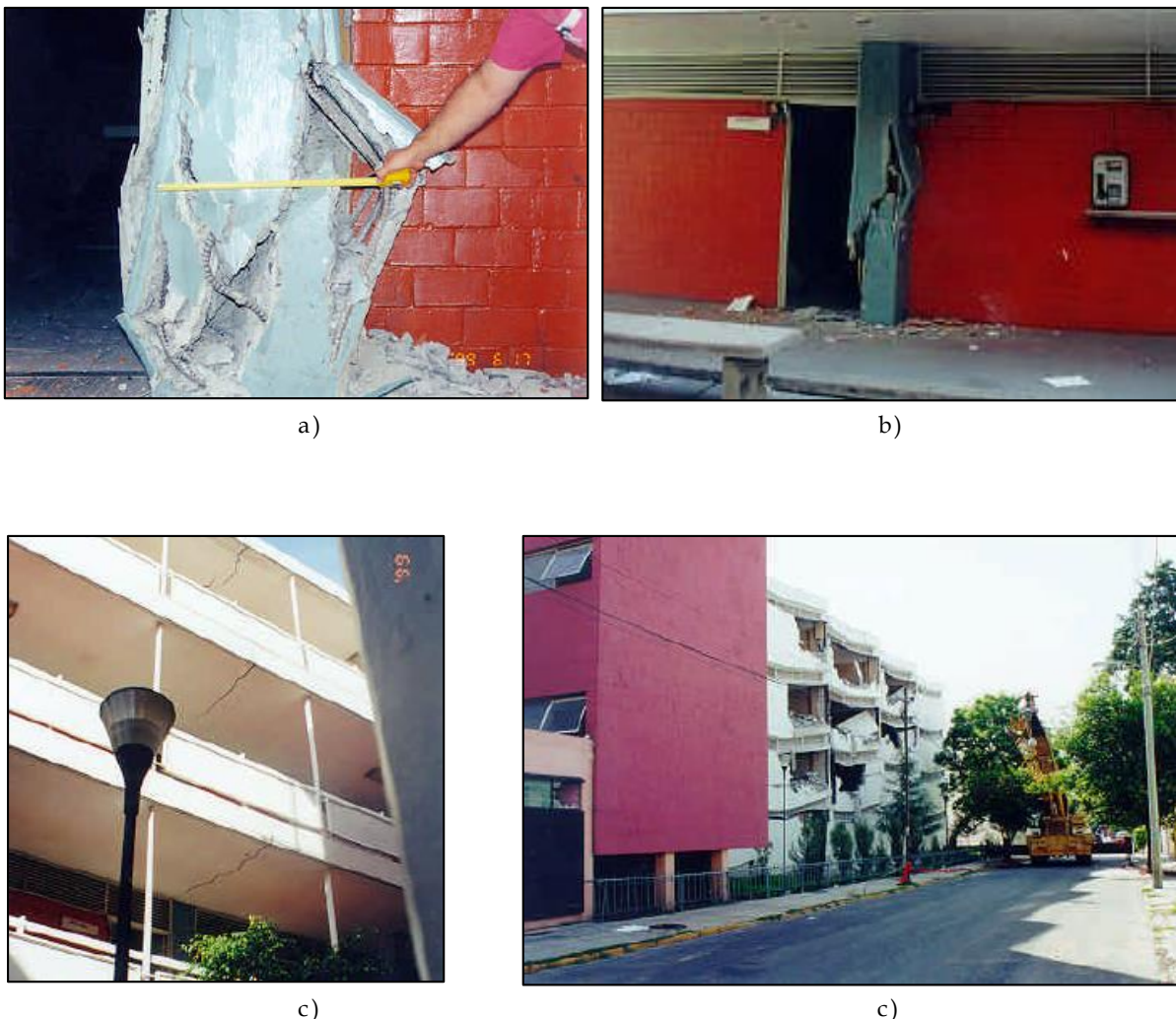
Figura 1.5 Daños típicos observados en construcciones escolares. (CENAPRED) "Informes técnicos. El sismo de Tehuacán del 15 de junio de 1999., México"; a) Formación de articulación plástica, b) Falla en columna, c) Daño en losas por flexión y c) Demolición de fachada frontal.
