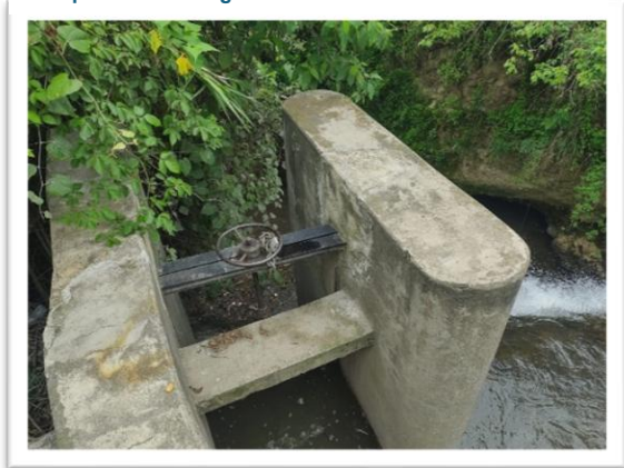
Fotografía de campo 1. Sistema de desvío de aguas del río César para uso de riego.
