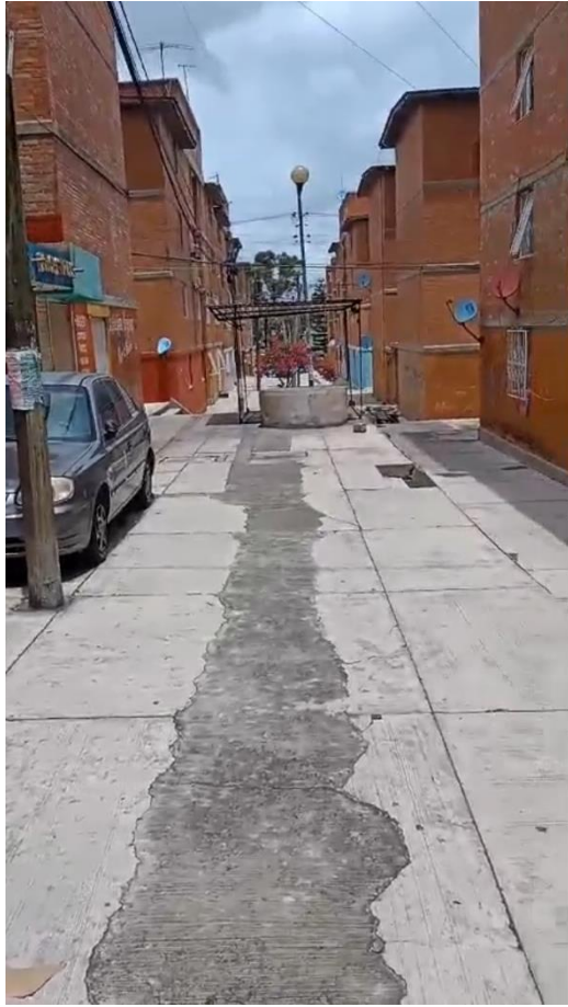
Fotografía 14 Edificaciones e instalación eléctrica 01 – Elaboración propia – 01-06-24, Unidad habitacional Margarita
