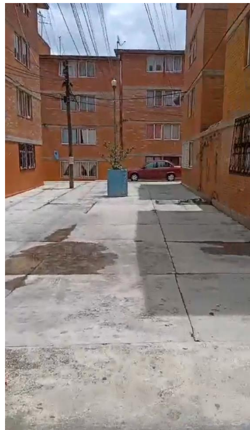
Fotografía 13 Edificaciones e instalación eléctrica 02 – Elaboración propia – 01-06-24, Unidad habitacional Margarita
