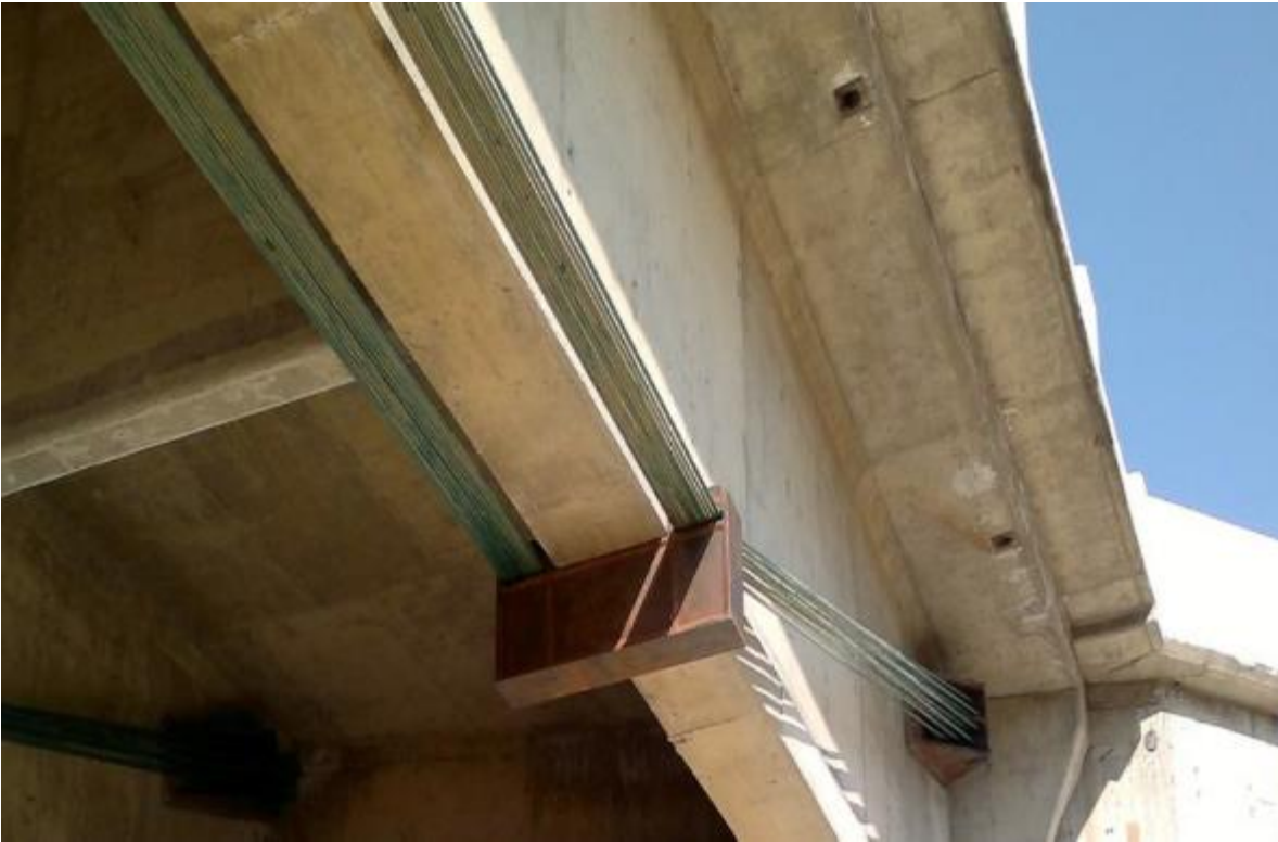
Figura 44 Desviador de torones externos, imagen recuperada de (Reestructuración de Puentes)
