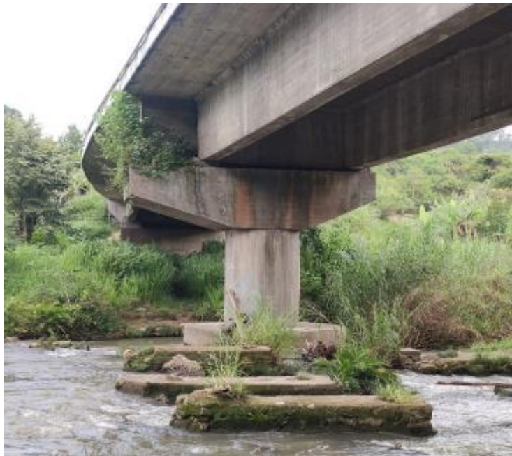
Figura 5 Puente Cántela, Chiapas, Presencia de vegetación y humedad en algunos elementos, autoría propia 2021.
