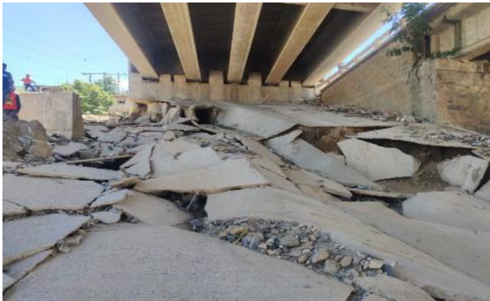
Figura 8 Puente Papagayo, Guerrero, daño en cono de derrame, autoría propia 2022.
