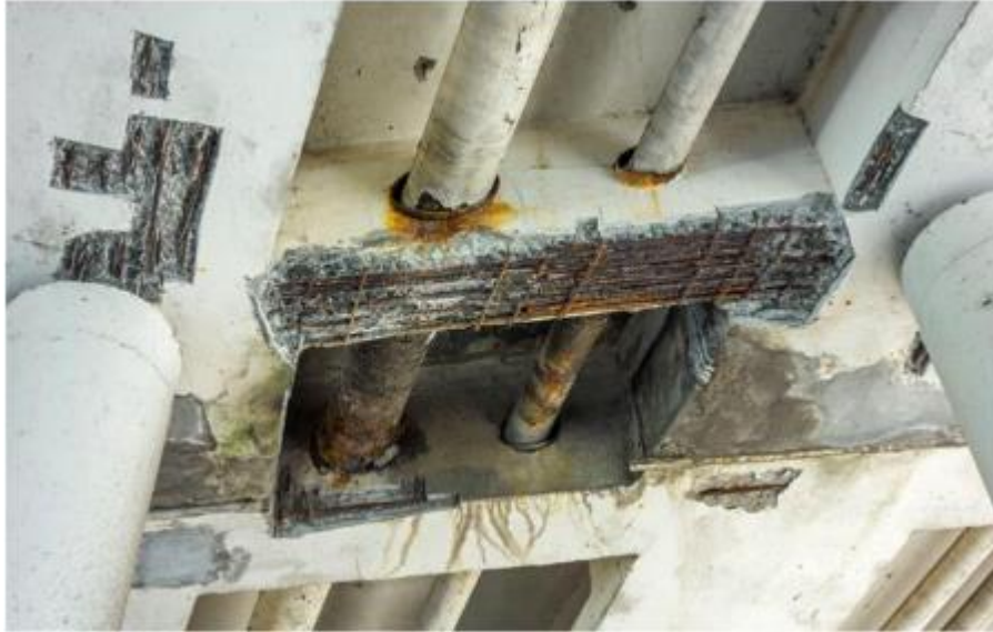
Figura 11 Acero de refuerzo con corrosión en puente de los 60's en Mariakerke, Flandes Oriental, Bélgica (Philippe, 2020).
