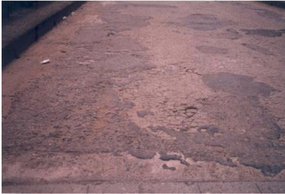
Figura 7 Puente Santo Domingo Oaxaca, Grietas en la superficie del concreto, daño estructural por sobrecarga (ing. Ruber Farias Aldaraca 2008)
