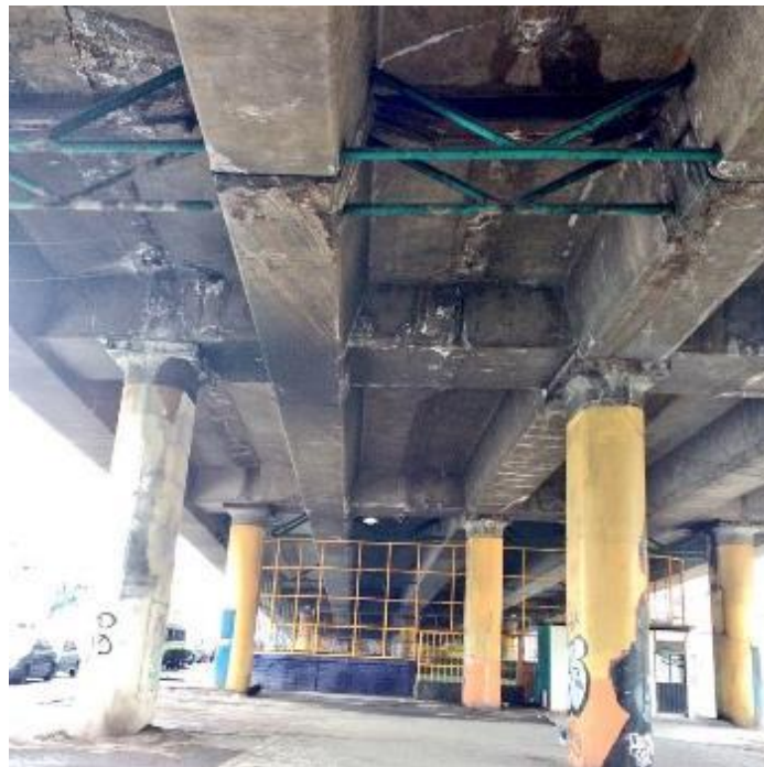
Figura 9 Presencia de humedad en trabes de puente vehicular avenida Tláhuac, (Garrido, 2023)
