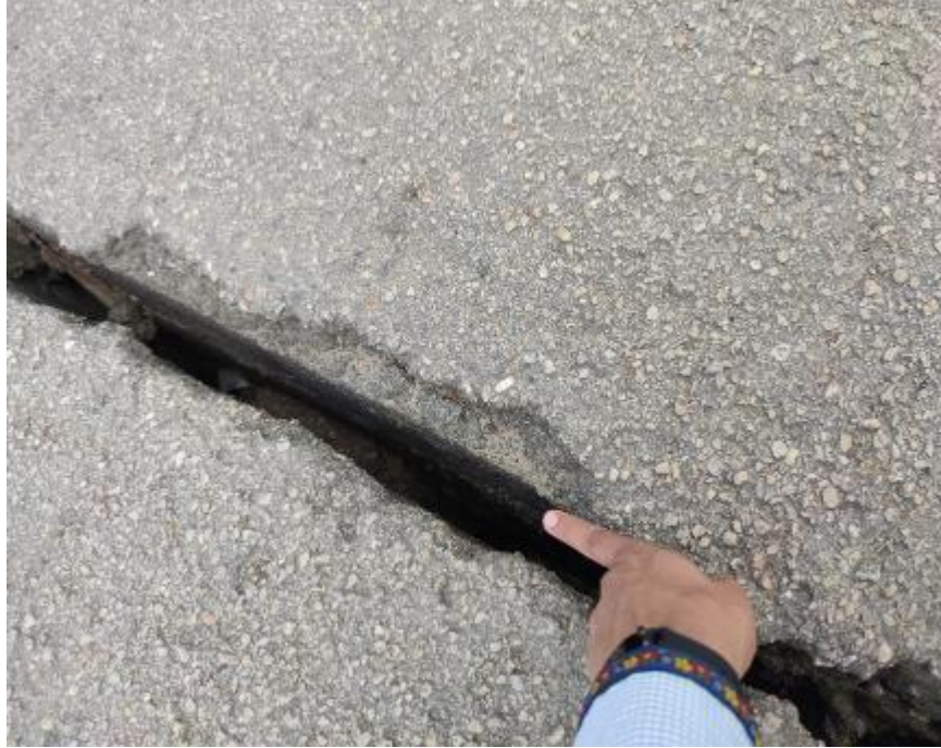
Figura 6 Puente Chamula, Chiapas, Juntas sin elemento de sello, autoría propia 2021.
