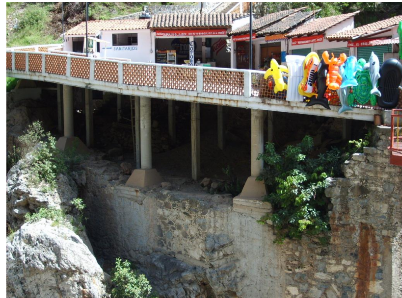
Imagen 2.5.3. En la entrada principal de los baños termales, existen construcciones adaptadas a la topografía, tirando sus desechos al río, descuidando el aspecto que esto origina, sin respeto hacia el medio ambiente. (Foto: Jesús Romero Solís. Julio 2008)
