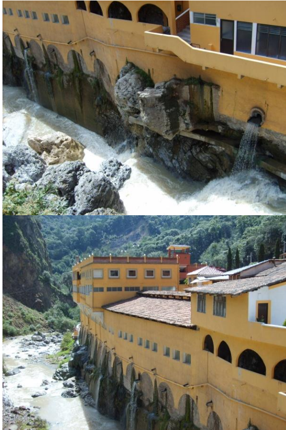
(Imagen 2.2.2.) Salida de aguas grises y negras de los baños hacia el río que en algún tiempo corría agua limpia, provocando un desagradable olor y apariencia, prácticamente en la entrada principal de los Baños Termales de Chignahuapan. Ejemplo de un mal diseño arquitectónico e ignorante planeamiento urbano del lugar. (Foto: Jesús Romero Solís. Julio 2009)
