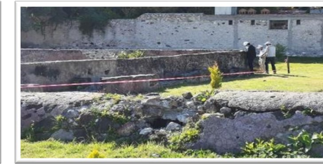
Figura 7. Ruptura de ducto cubierto (Archivo MACPE, 2020).
