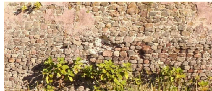
Figura 24. Disgregación de juntas de mortero, pérdida de elementos de mortero, flora parasita en muro de contención este interior (Magdaleno, 2021).
