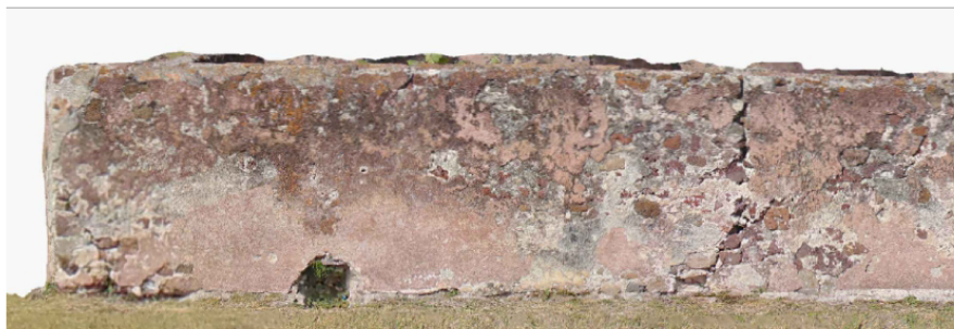
Figura 26. Grieta vertical, muro mamposteria pretil exterior este (Magdaleno, 2021).
