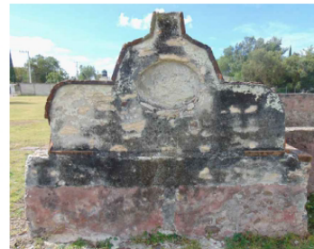
Figura 4. Deterioros muro hastial ejes 2-7 (Magdaleno, 2021).
