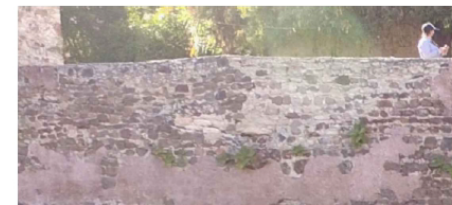
Figura 13. Deteriores en muro oeste interior, intervención anterior, flora parasita (Magdaleno, 2021).
