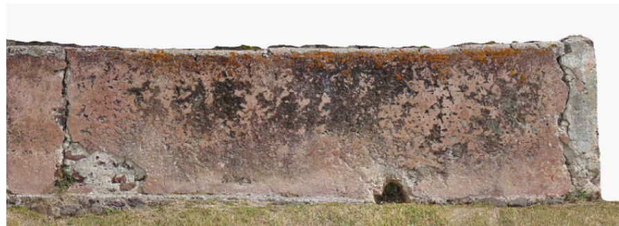
Figura 22. Fracturas en muro pretil sur exterior (Magdaleno, 2021).
