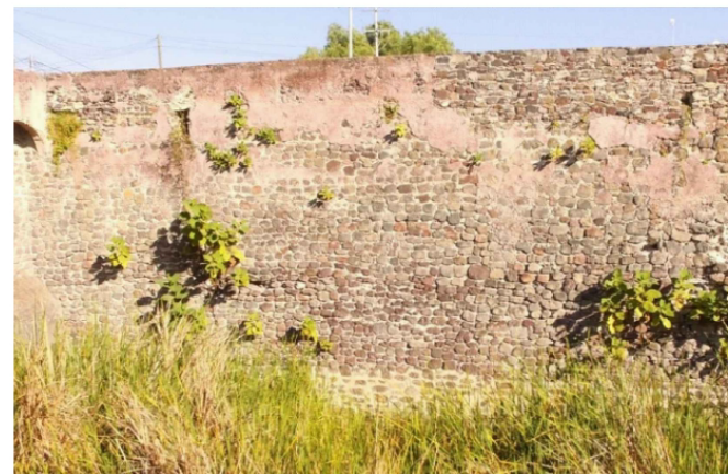
Figura 23. Deterioros generales en muro de contención este interior (Magdaleno, 2021).
