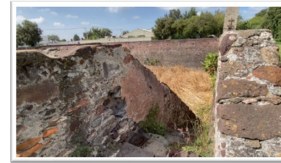
Figura 6. Deterioros detectados en acceso de escalera del Aljibe (Magdaleno, 2020).
