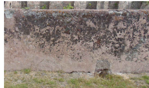
Figura 20. Oscurecimiento por microorganismos, muro pretil sur exterior (Magdaleno, 2021).
