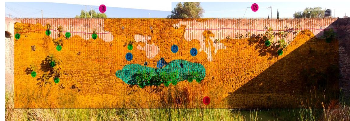
Figura 41. Trazado de daños identificados con imágenes superpuestas en planos base
