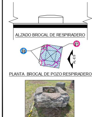
Figura 7. Faltante de elementos de mampostería en brocal de respiradero (Magdaleno, 2021).
