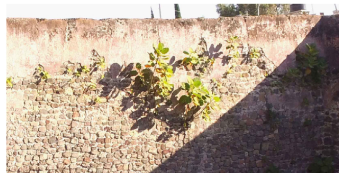
Figura 25. Fisuras y crecimiento de flora parasita en desplante de muro pretil interior este, (Magdaleno, 2021).
