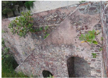
Figura 10. Deterioros generales alfardea lado oeste (Magdaleno, 2021).
