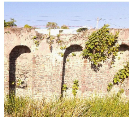
Figura 2. Deterioros entre ejes 7-9 (MACPE, 2020).
