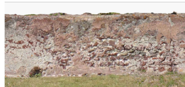
Figura 27. Desprendimiento aplanados, perdida del juntas de mortero, muro mamposteria pretil exterior este (Magdaleno, 2021).
