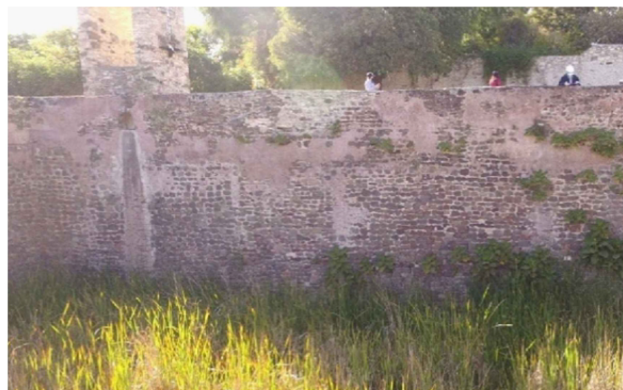
Figura 14. Deteriores generales, muro oeste interior, oscurecimiento, flora parasita, perdida de juntas de mortero (Magdaleno, 2021).
