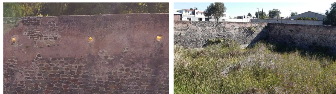
Figuras 35 y 36. Vanos abiertos en muro perimetral, izquierda. Flora invasiva, derecha (Magdaleno, 2021).
