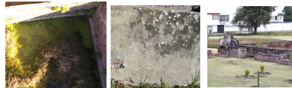
Figuras 30, 31, 32. Flora invasiva superior y líquenes presentes en el Aljibe ; muro hastial con presencia de microorganismos (Magdaleno, 2020).
