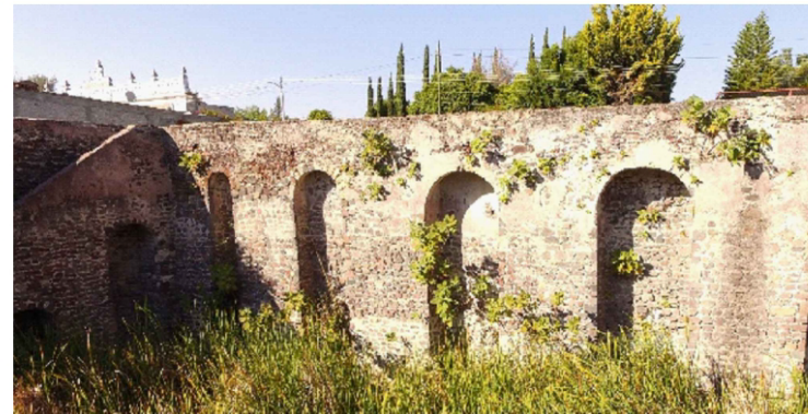
Figura 1. Deterioros generales del muro norte entre ejes 2-7 (MACPE, 2020).
