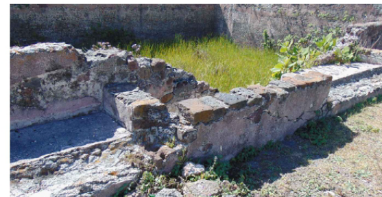
Figura 6. Colapso de muro sobre arco 6 (Magdaleno, 2021).
