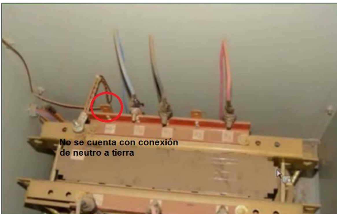
Figura 4.1.7 Transformador que no cuenta con conexión de neutro a tierra [21].
