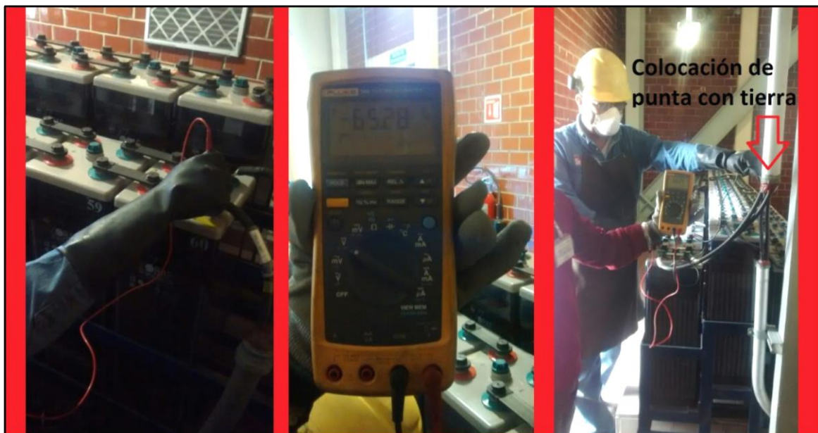
Figura 3.2.1 Medición con multímetro de voltaje de positivo a tierra.
