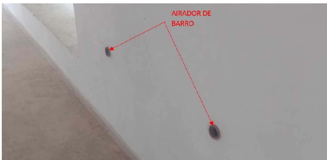
FIGURA N°33 Airadores en muro de construcción histórica. (Fuente: Propia).
