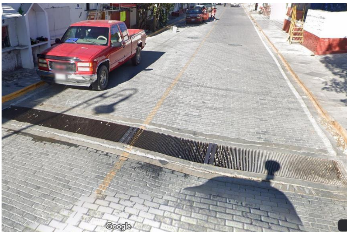
Imagen 13. Rejilla de captación de agua pluvial. Obtenida de Google Maps, https://www.google.com/maps/@18.9018898,97.9719595,3a,46.6y,269.3h,65.95t/data=!3m6!1e1!3m4!1s7HhA6Jbeydb13DnAgGnyFA!2e0!7i16384!8i8192?entry=ttu
