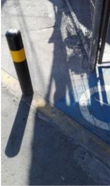
Imagen 2.0: Obstrucción de las rampas por construcciones privadas que evidentemente invaden el espacio público.
