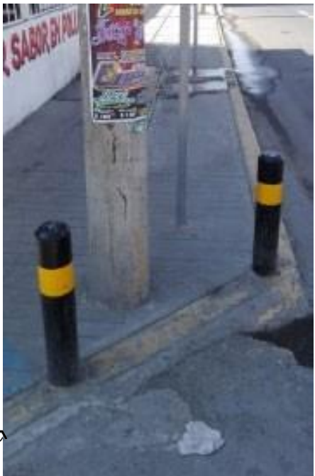
Imagen 2.1: Obstrucción de las rampas por postes del servicio de electricidad evidentemente mal colocados, además que los bolardos y la señalética colocada de manera burda, limita en su totalidad el paso a los peatones con mayor dificultad de movilidad.
