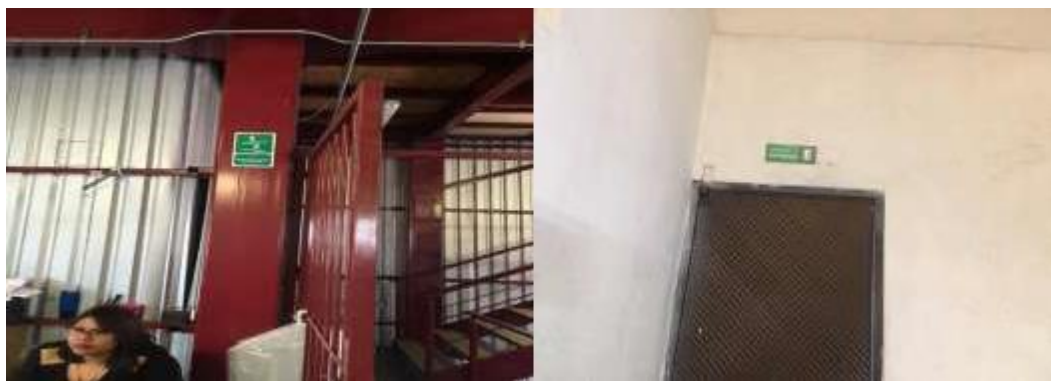
FIGURA 44. SEÑALÉTICA SALIDAS DE EMERGENCIA
