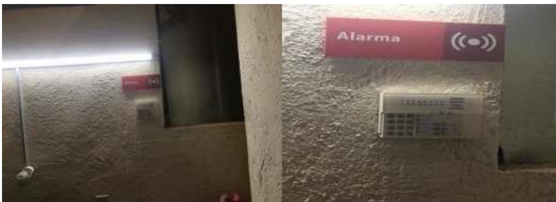
FIGURA 42. Alarmas de evacuación
