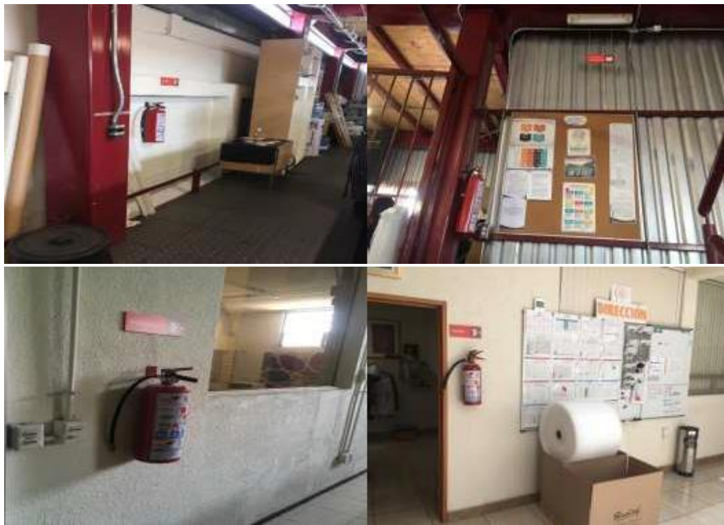
FIGURA 44. SEÑALÉTICA DE EXTINTORES
