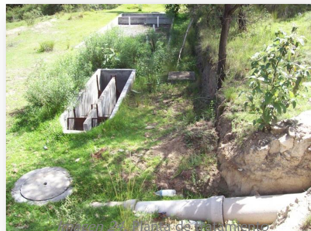
Imagen 23. Planta de tratamiento
