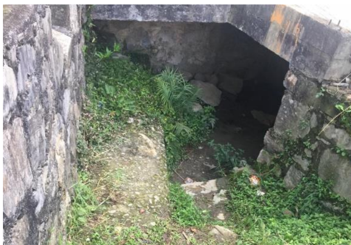
Figura 4. Obstrucción del arroyo
