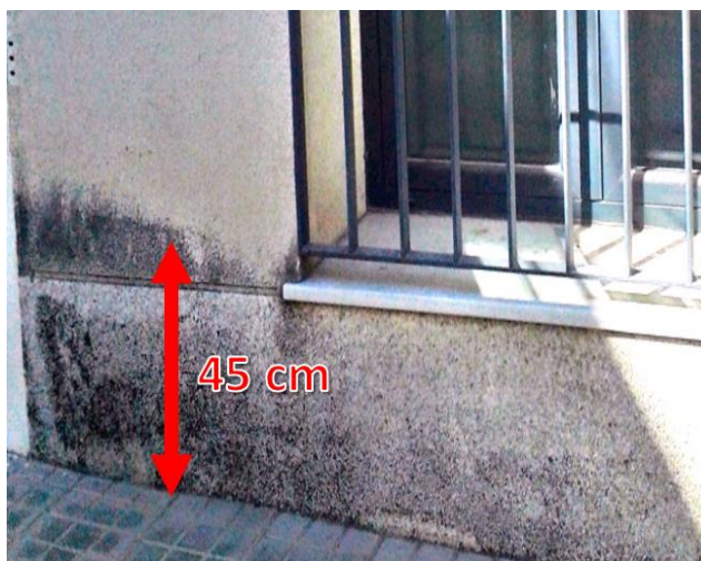
Figura 3. Nivel de agua en viviendas
