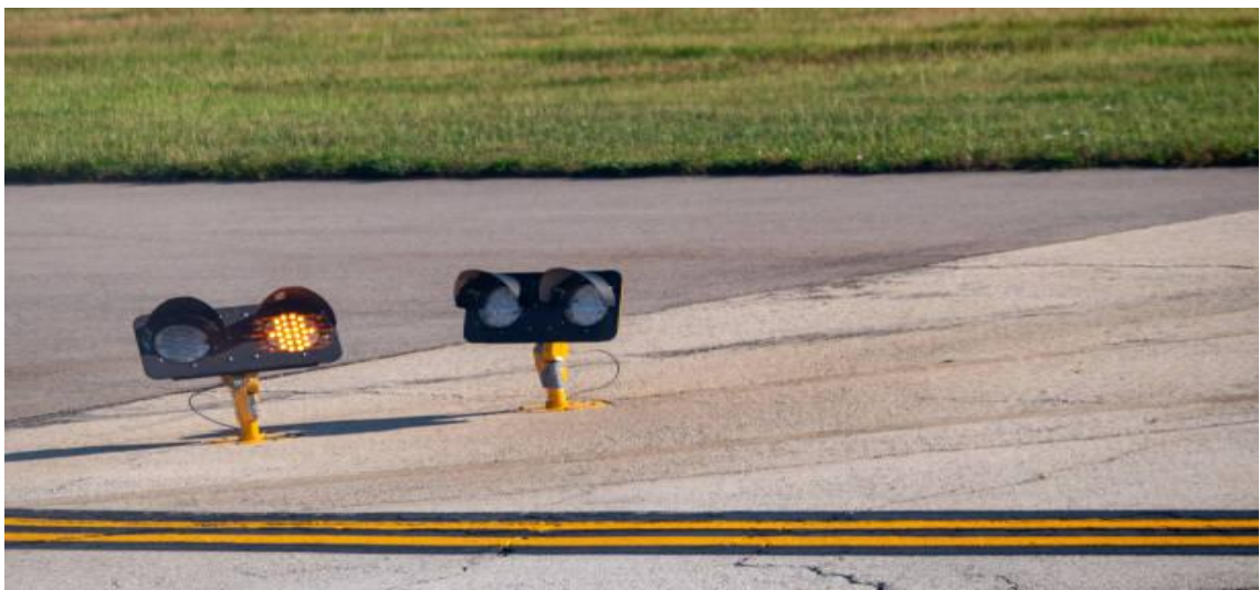
Imagen 40. Semáforos de pista en aeropuerto. Fuente: https://www.istockphoto.com/es/foto/sem%C3%A1foros-de-pista-del-aeropuerto-en-amarillo-precauci%C3%B3n-durante-el-d%C3%ADa-gm1173085986-325688591
