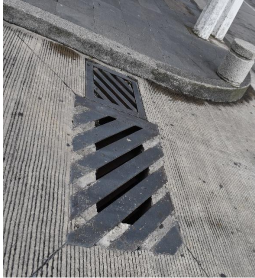
Imagen 12. Alcantarillado en la calle 1 entre avenidas 3 y 5, Córdoba, Veracruz. Autor: Elvia Mendoza Ledo. Fecha: agosto 2021.
