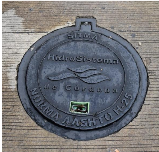
Imagen 13. Tapa de Hidrosistema en la calle 1 entre avenidas 3 y 5, Córdoba, Veracruz. Autor: Elvia Mendoza Ledo. Fecha: agosto 2021.
