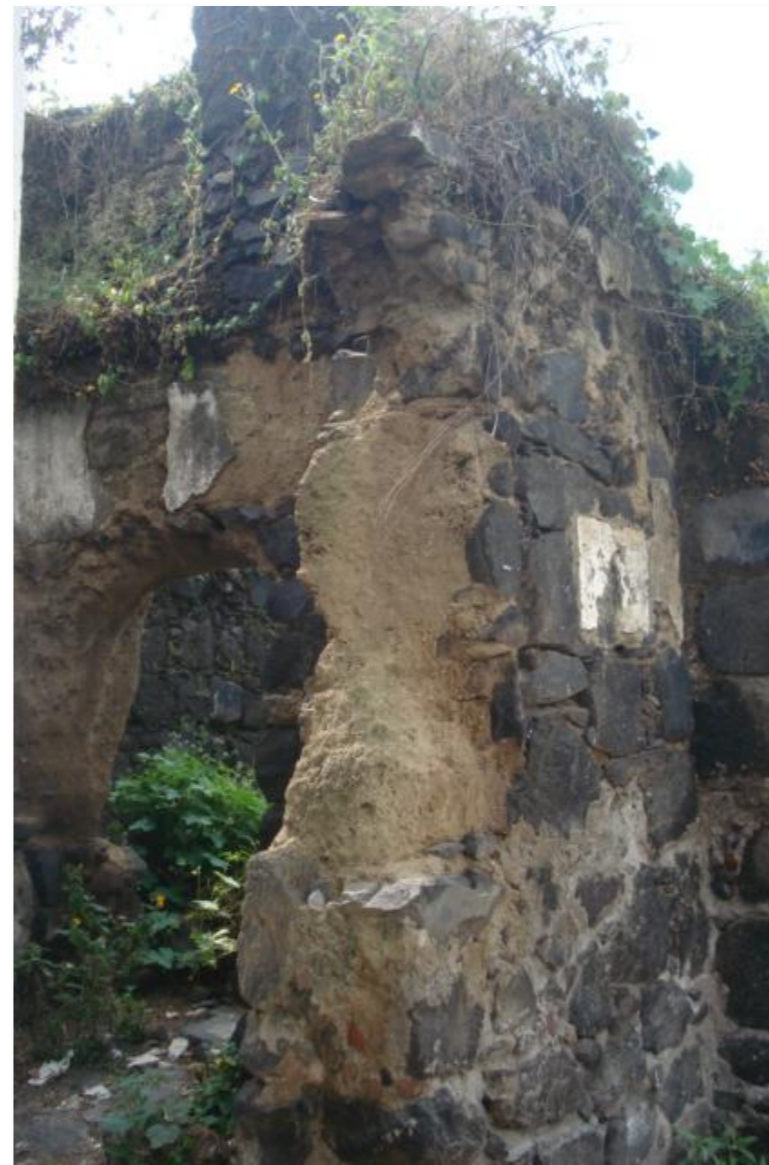
Fotografía tomada en la localidad de San Pedro Atlixco, muro de adobe con piedra volcánica
