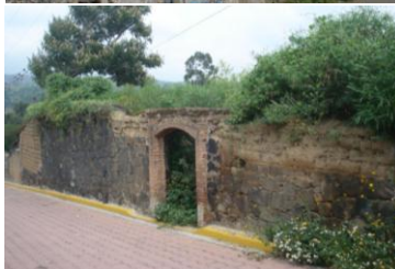
Resto de muro de lo que fue una vivienda en calle Josefa Ortiz de Domínguez, con el uso de piedra, adobe, y en el acceso principal se repite el arco de medio punto
