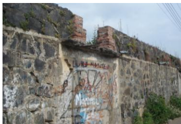
Vivienda deshabitada en calle prolongación Avila Camacho, con un aspecto sucio y descuidado.
