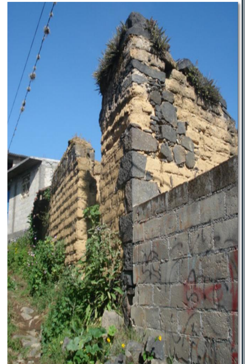
Fotografía tomada en la localidad de San Pedro Atlixco, se puede observar el apoyo en las esquinas formado por piedra volcánica lo que fue sustituido por acero.
