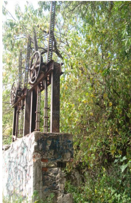
Compuertas de la hidroeléctrica, aun en sitio.
