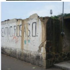
Muro de adobe con repellado, ubicado prolongación Avila Camacho, entre calle Josefa Ortiz de Dominguez y 16 de septiembre
