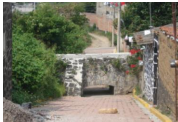
Puente peatonal ubicado en calle Josefa Ortiz de Domínguez, se emplea la piedra volcanica con cemento. Las casas vecinas con materiales de la región.
