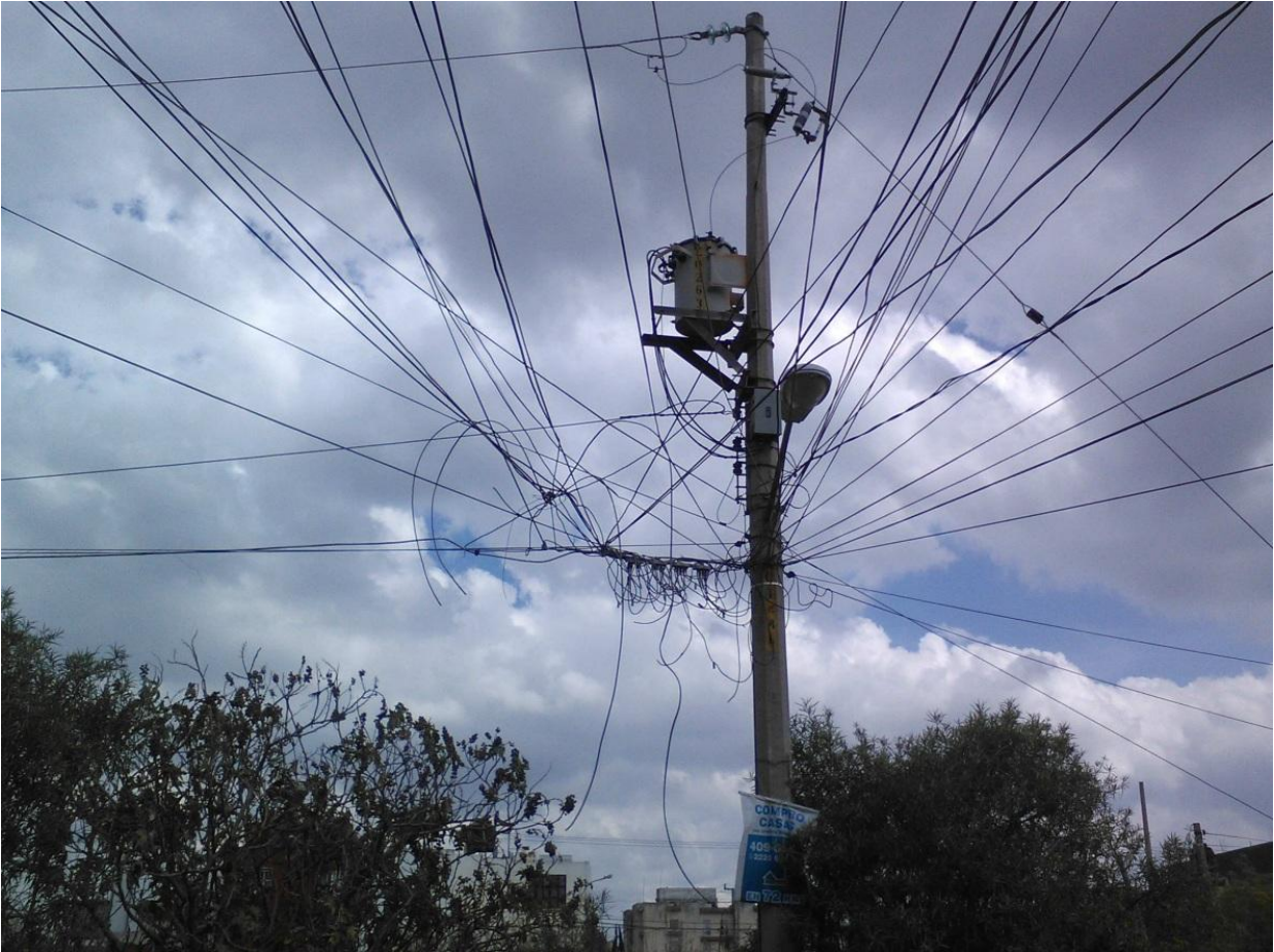
Fig. 2.12 Toma ilegal del servicio de luz. En la calle 2 poniente
