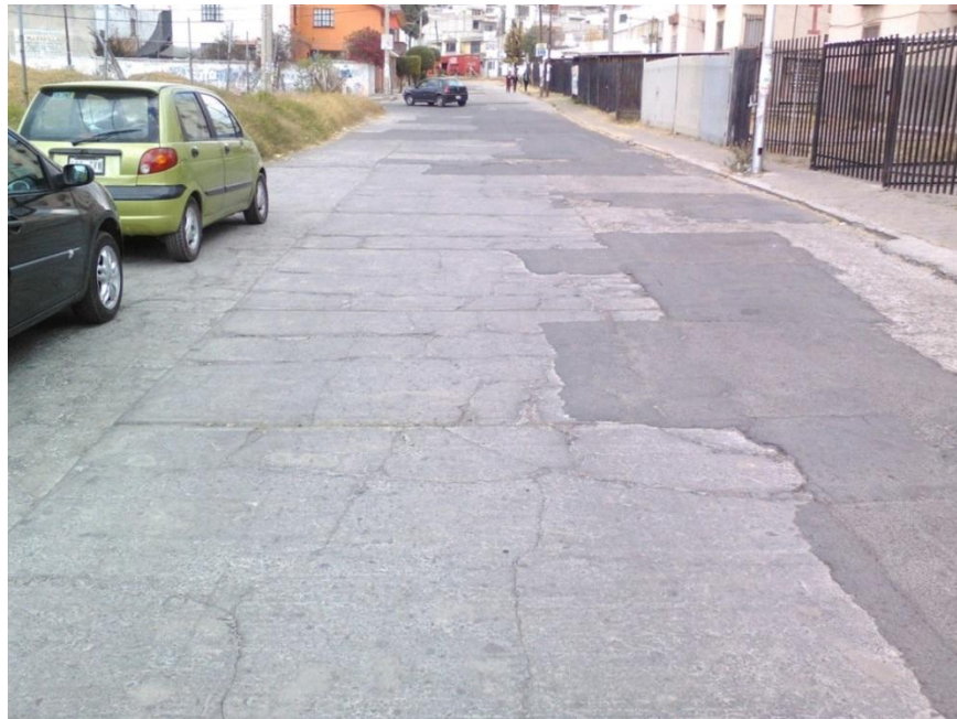
Fig. 2.7 Vialidad parchada con chapopote.
