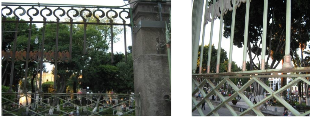
Ilustración 68 Perdida de elementos en tramos (Foto del Autor 2014)
