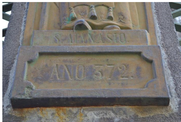
Ilustración 65 Presencia de Orín en la superficie metálica (Foto del Autor 2014).
