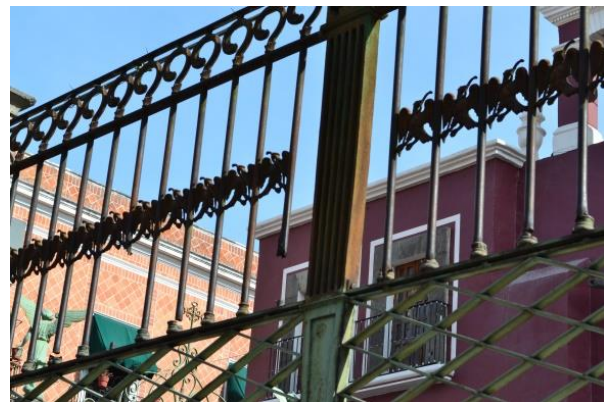
Ilustración 64 Corrosión y oxidación del metal. (Foto del Autor 2014)
