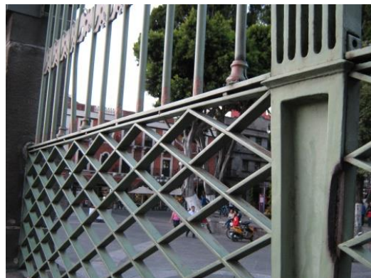
Ilustración 62 Depósito de suciedad y contaminación en la superficie de la Herrería. (Foto del Autor 2014).
